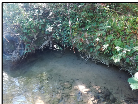
Figure 59 : Affouillement des berges (T5)
