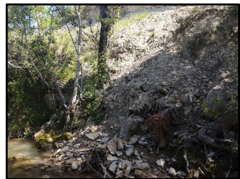
Figure 13 : Forte érosion rive gauche (T4)
