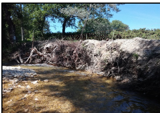
Figure 31 : Clôture en rive droite avec forte érosion (T9)
