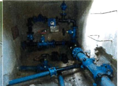
Chambre de vannes réservoir
