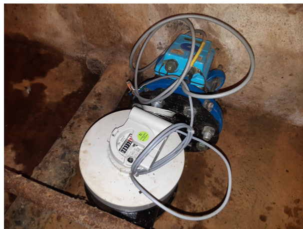
Distribution réservoir Haut
