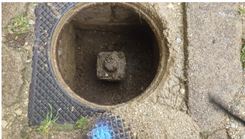
Ventouse sur réseau
