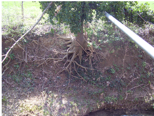
Affouillement important des berges
