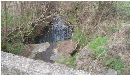
Affouillement du radier du pont des Tibolettes
