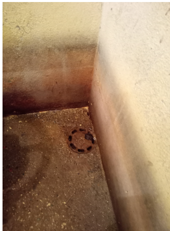
Figure 23 : Bonde sujette à des intrusions d'eau en provenance du marais
