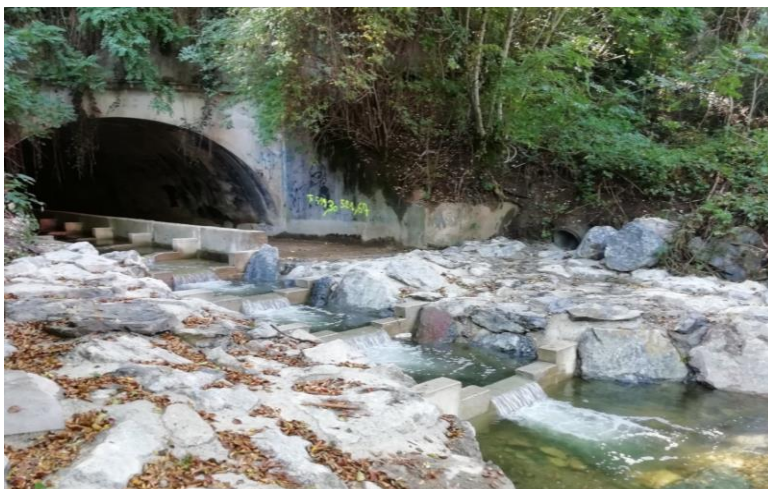
Exemple de pré barrages réalisés sur un affluent de l'Ondaine (Source EGIS)
