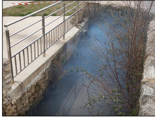
Anomalie 9 – Exutoire trop-plein communiquant entre Rv2 et le canal d'irrigation
