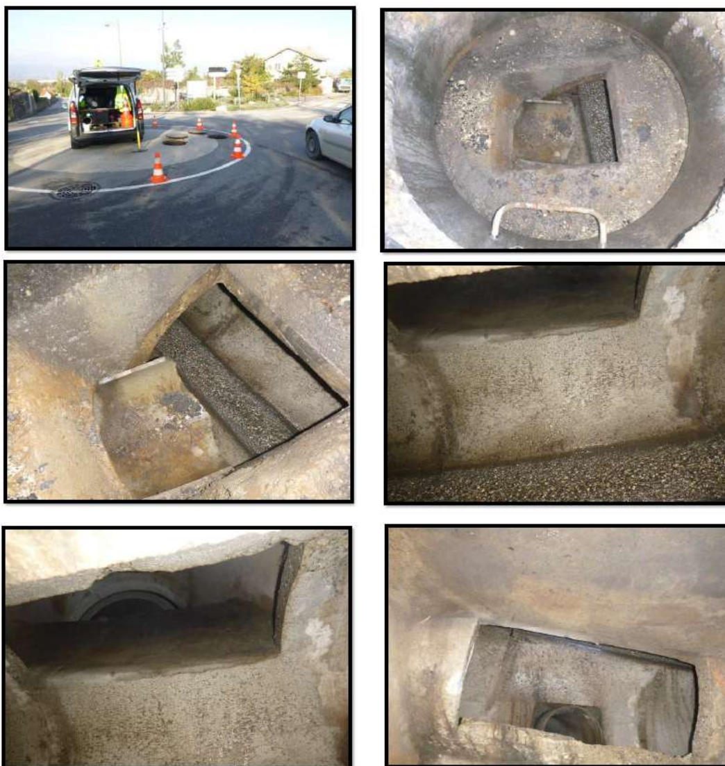
Figure 42 : Photos du délestage pluvial à Etoile-sur-Rhône
