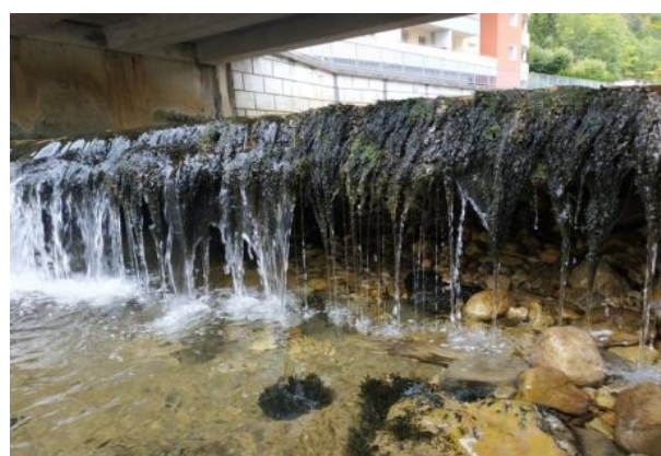
Dalle sous-cavée à l'aval sur près d'un 1,5 m
