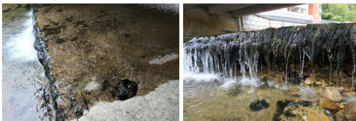
Fers à béton apparents et dalle percée à l'aval
