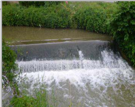
Seuil infranchissable sur l'Ozon, (SOM, été 2021)
