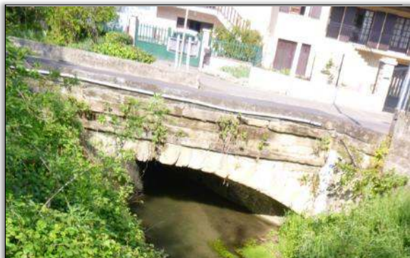
Pont sous dimensionné sur l'Ozon, (SOM, été 2021)
