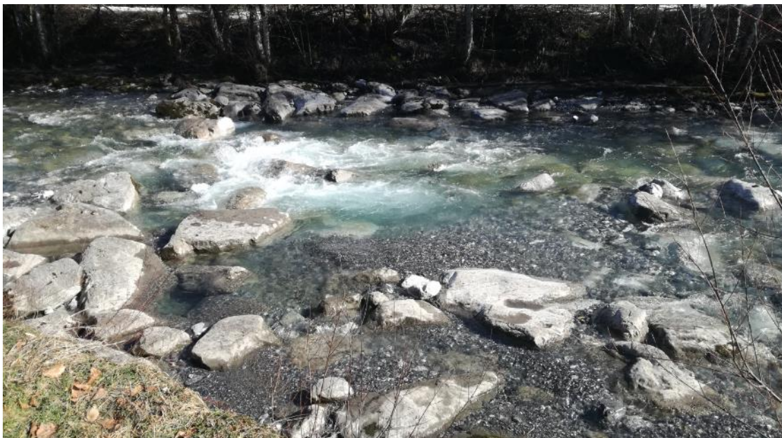
Figure 55: Clévieux seuil1 - érosion du pied et création d'une fosse de dissipation
