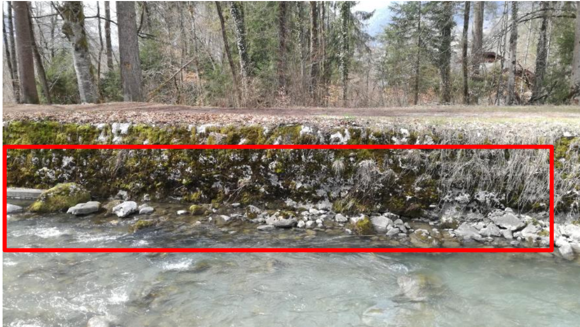
Figure 16: Clévieux désordre 534 digue du Becchi
