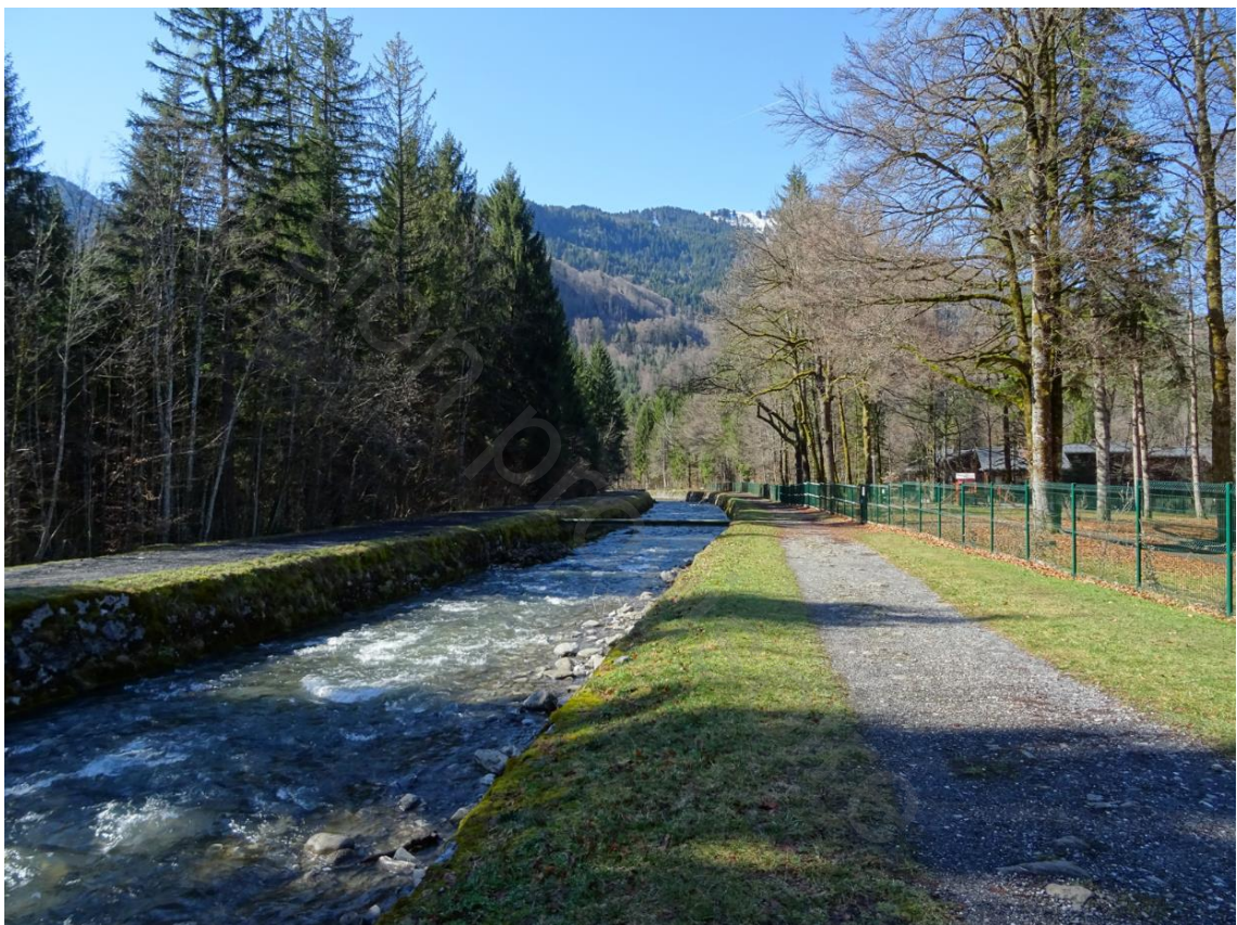
Figure 43:Clévieux - PT 17 - Digue du BECCHI- Etat actuel.
