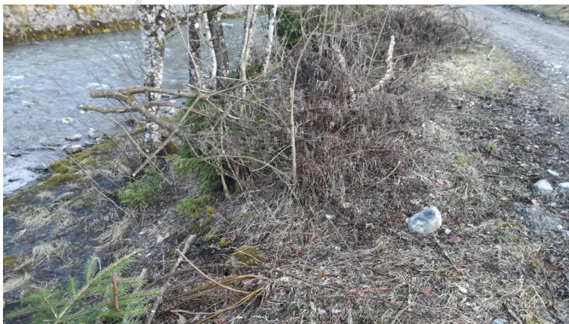
Figure 19: Clévieux rive gauche - Digue aval RD 907 - Désordre2736 - Anse d'érosion
