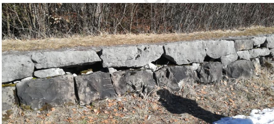
Figure 69: Digue du Grand Massif Express - Déjointement du perré
