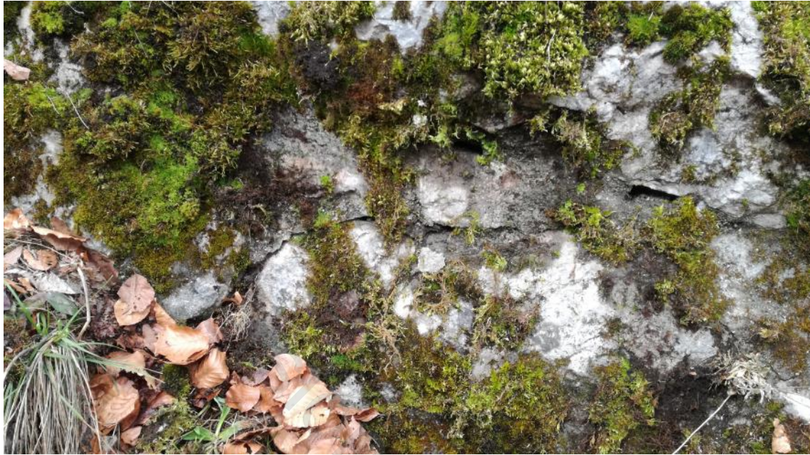
Figure 20: Clévieux rive droite - Digue des Becchi - Désordre 160
