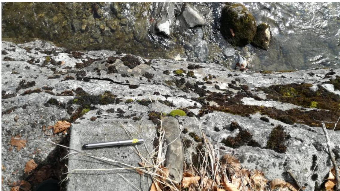
Figure 21: Clévieux rive droite digue du Becchi - Désordre 540
