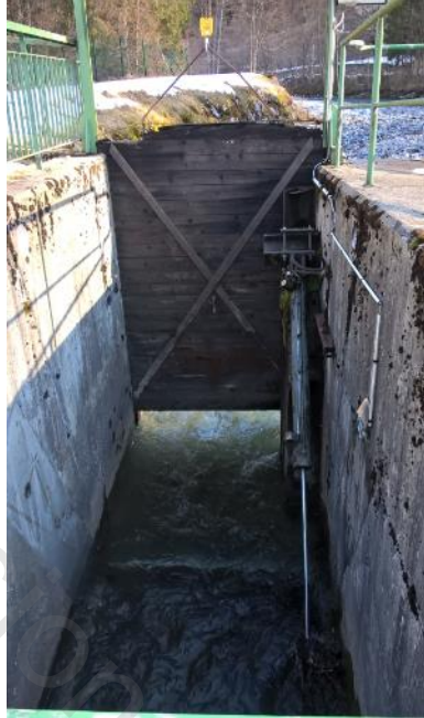
Figure 93: vanne d'alimentation du lac aux Dames
