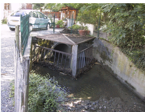
grilles pour retenir les corps flottants avant un passage busé
