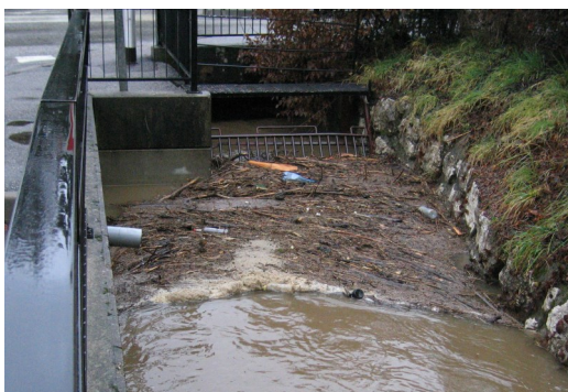
montée d'eau et rétention des corps flottants par une grille
