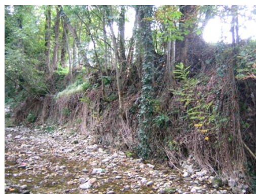
risque d'arra- chage : robiniers instables sur le haut d'un mur en pierres vertical (l'ouvrage n'est presque plus visible)
