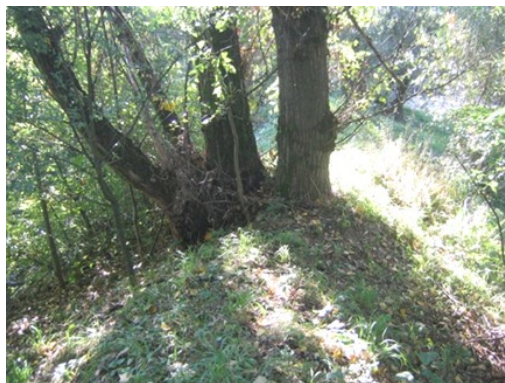
risque de brèche : peupliers sur le haut d'une digue
