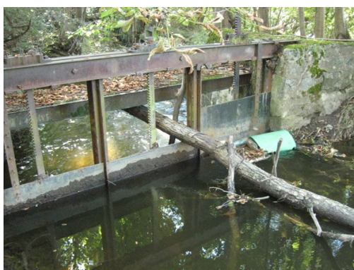
blocage de bois dans une prise d'eau
