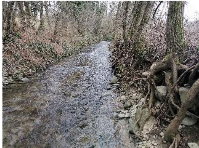
Figure 75: Affouillements de berge (01/21)
