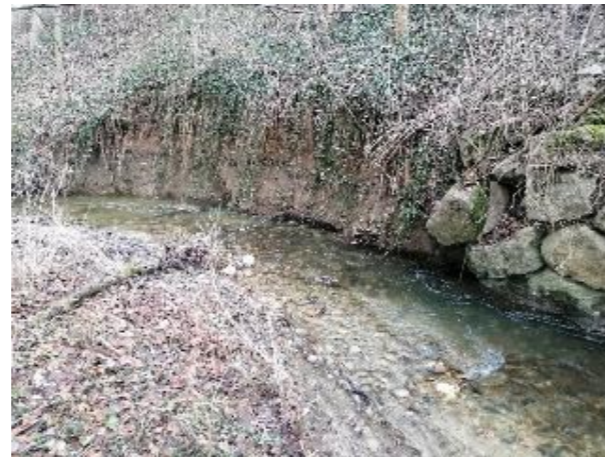
Figure 62: Enrochements et dégradations en berges (01/21)
