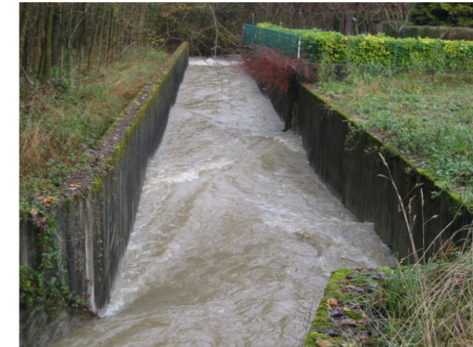
Figure 94: Section bétonnée amont RD3 - Passage en écoulement torrentiel, le bétonnage des rives favorise l'accélération des écoulements. En bas à droite, l'exutoire réseau d'eau pluvial de la zone industrielle des grands champs (15/11/2002)
