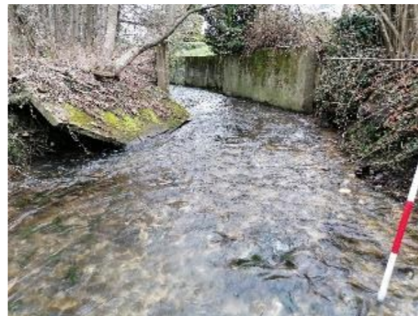
Figure 64: Amont section bétonnée avec mur déchaussé en rive gauche (01/21)
