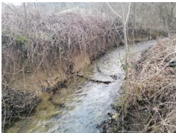
Figure 29: Erosions dans le tronçon amont de la traversée RD910 (01/21)
