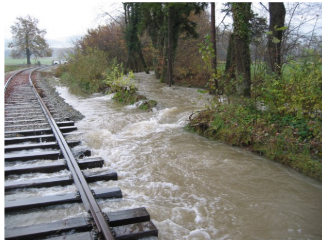
Figure 91: Débordement en rive droite au niveau de la voie ferrée système U (15/11/2002)
