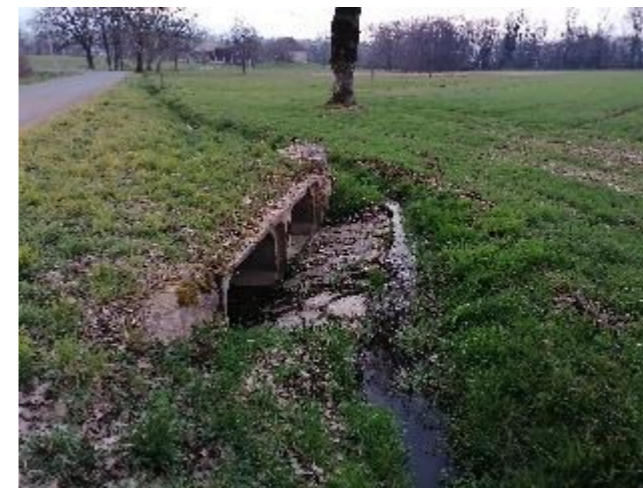
Figure 41: Double dalots de traversée de la RD240 pour alimenter la zone de Bel Air (03/21)
