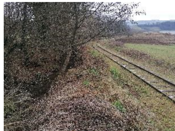
Figure 45: Digue et voie ferrée système U en rive droite, à l'aval du pont Hameau de Balvay - Talus au fond à droite (01/21)
