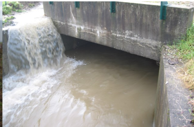
Figure 93: Ecoulement résultant de la vidange de l'inondation de la zone industrielle provoquée par le contournement par l'est du dépôt système U. Les trottoirs ont dû être détruits pour évacuer l'eau (15/11/2002)
