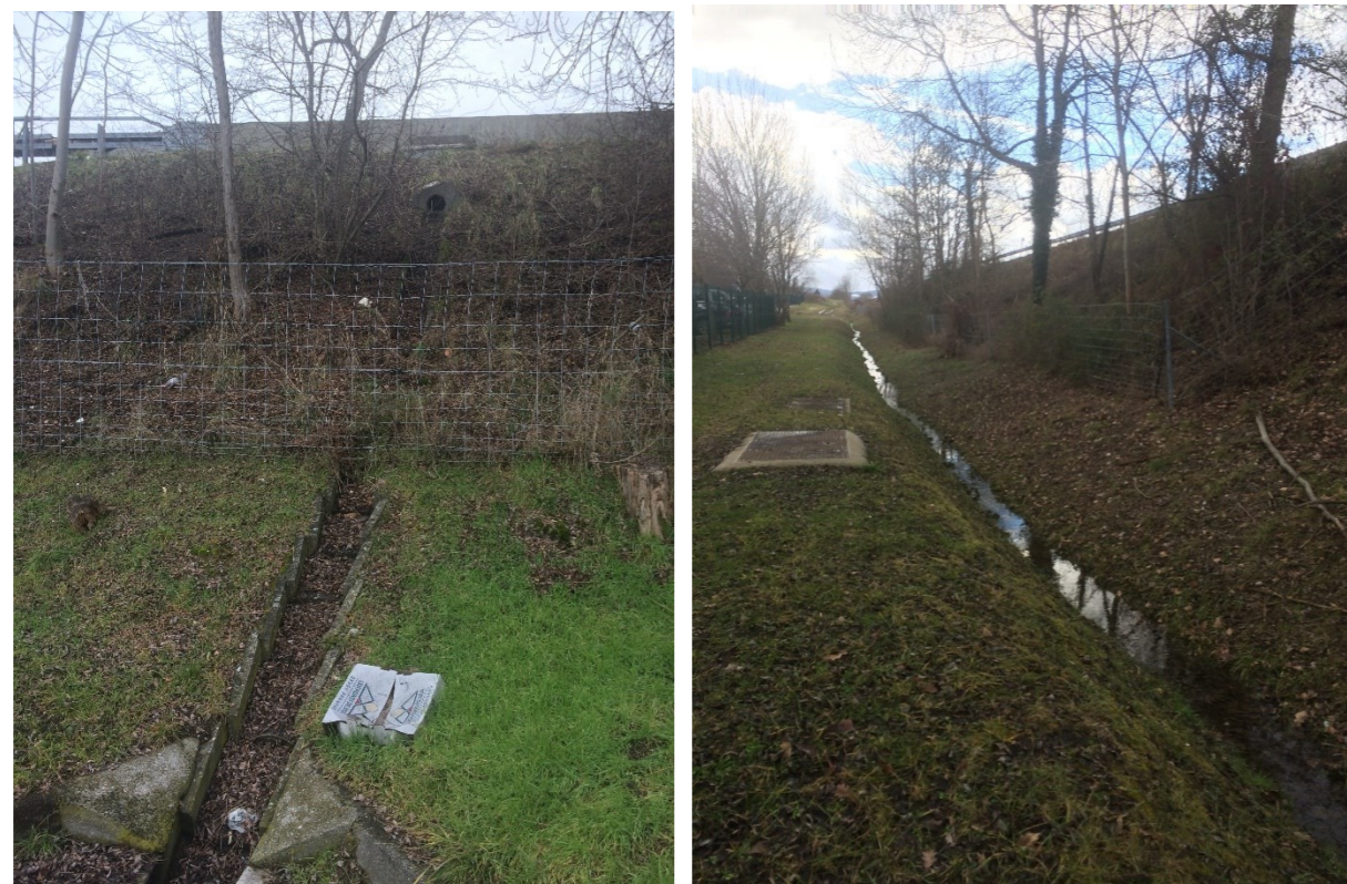
Figure 131: Evacuation des eaux pluviales de l'A41
