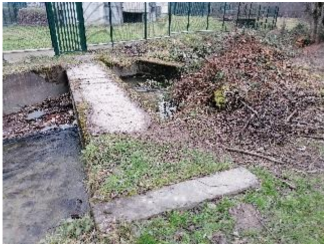
Figure 82: Conduites protégées à proximité du captage Nestlé avec embâcles (01/21)
