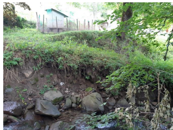
Erosion sur T1
