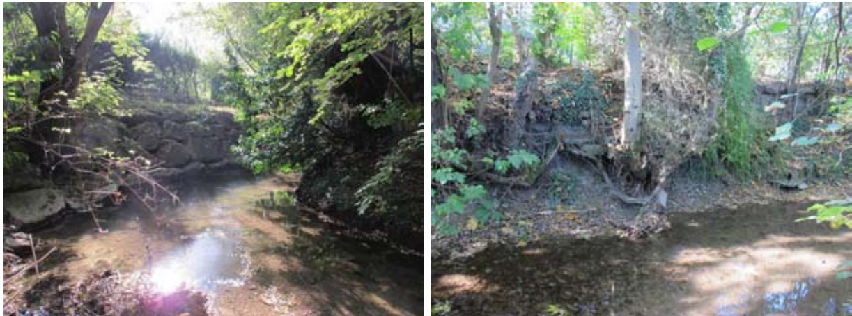
Exemples de protection de berge et de berge érodée
