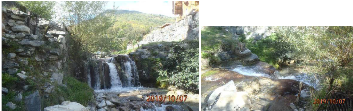
Figure 26 Le seuil de prise d'eau avec son couronnement dégradé
