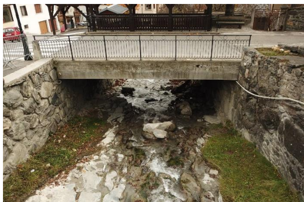
Faible hauteur du pont de l'Eglise (RD 89 – ETRM)
