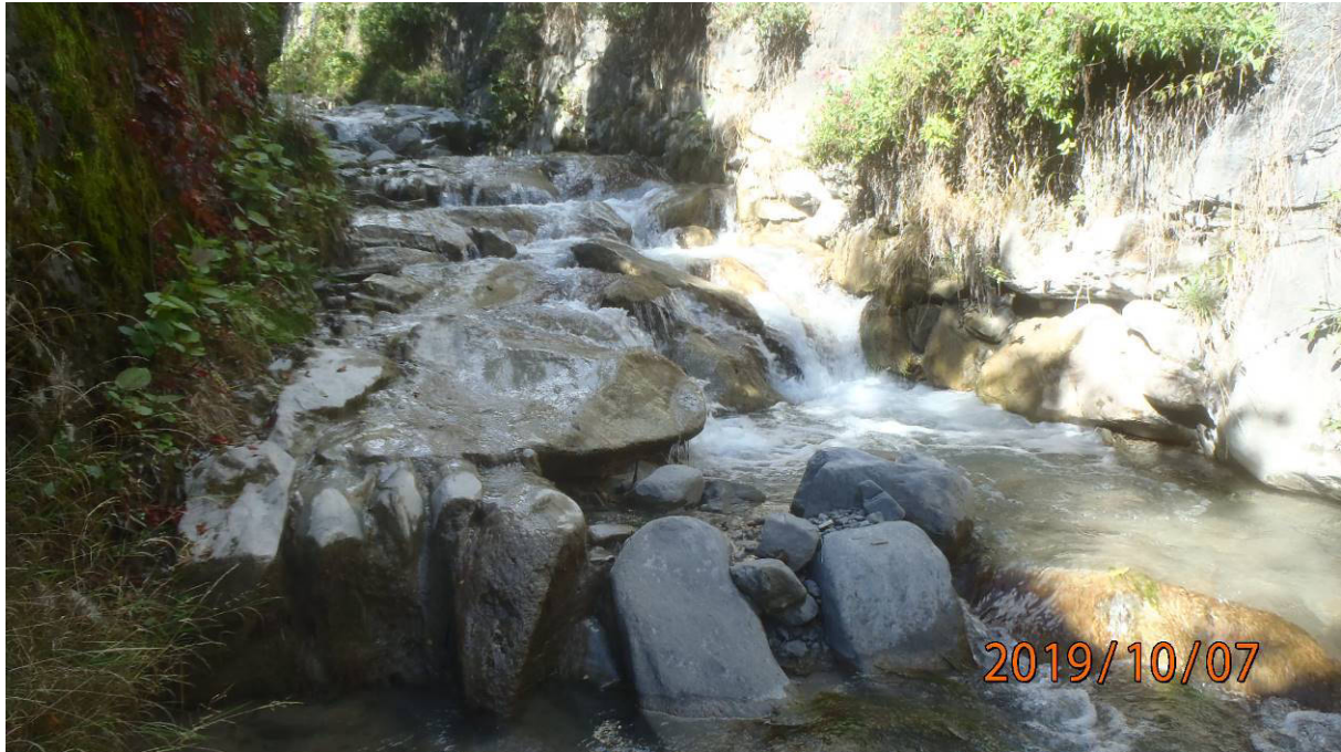
Figure 18 Restes d'un seuil de fixation du fond de lit (détruit sur la moitié de la largeur)
