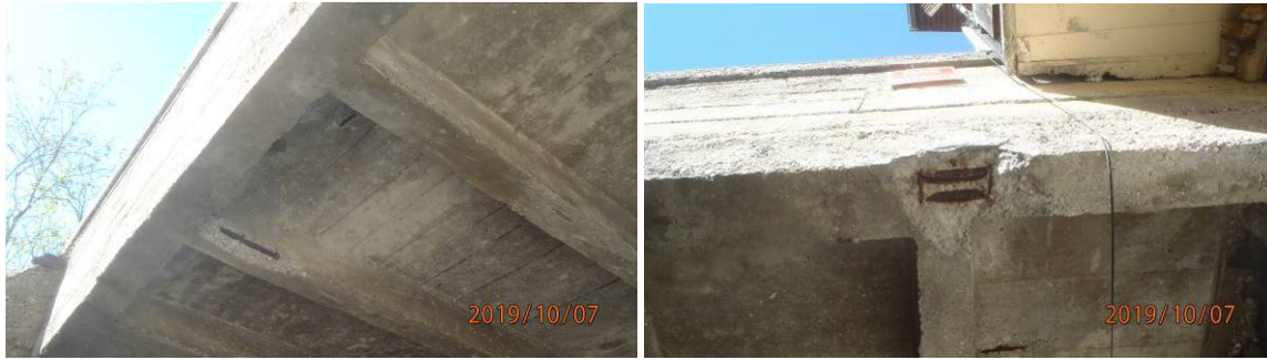
Figure 17 Le pont privé. La qualité du béton est très mauvaise. Elle a permis des infiltrations d'eau qui ont oxydé les aciers et donc fait éclater le béton. Une reprise en sous œuvre nous paraît indispensable.
