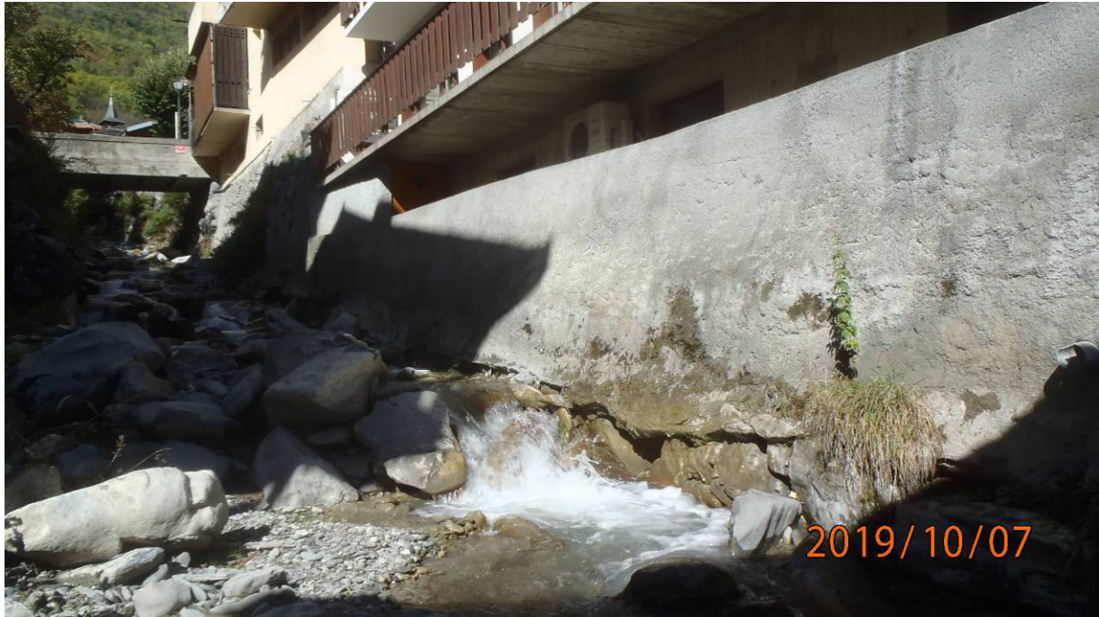
Figure 12 Détail de l'affouillement de rive gauche au droit de l'immeuble
