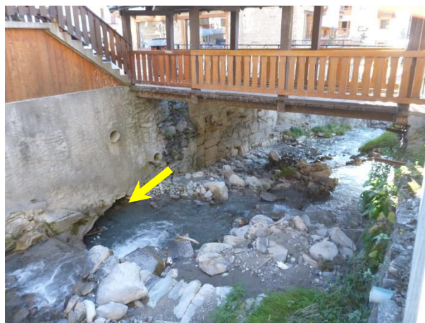
Affouillement sous le mur rive gauche en amont du pont de la RD 915
