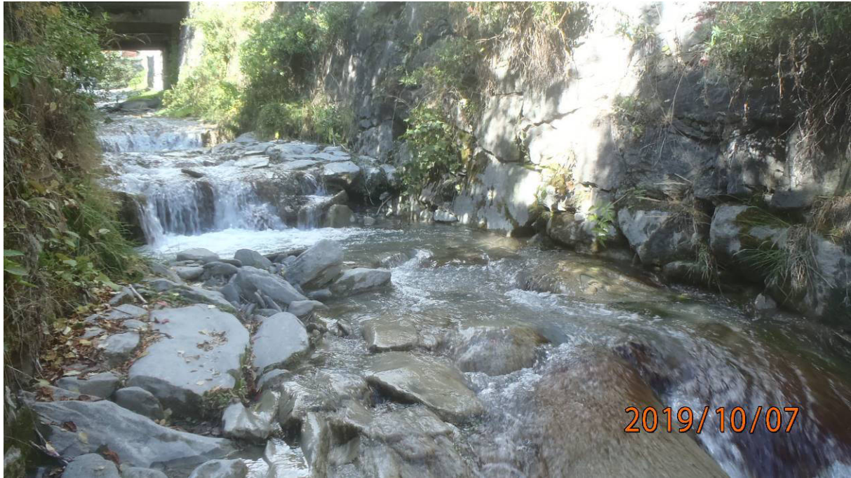
Figure 20 Partie du lit où près de la moitié de la surface du radier a été emportée
