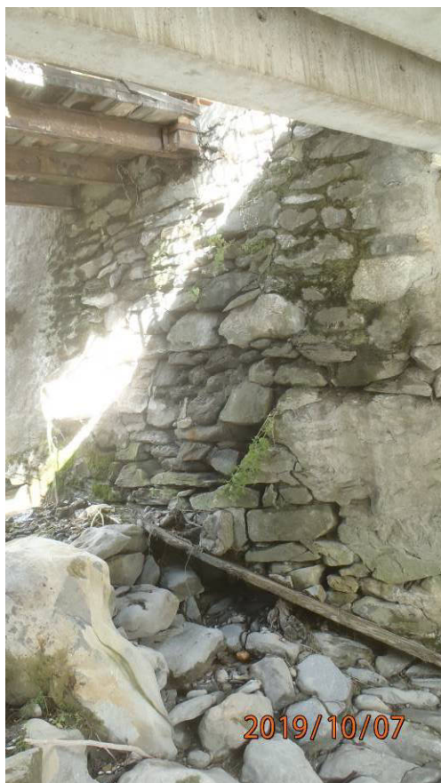
Figure 9 A l'aplomb de la passerelle piétonne. Le mur est assez dégradé avec un petit affouillement de pied et une maçonnerie qui demanderait à être rejointoyée.
