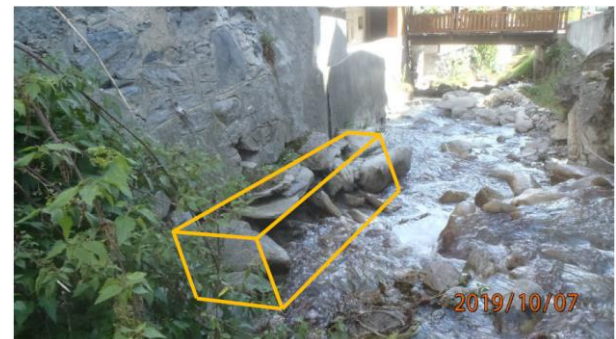
Variante 2 – Reprises localisées des désordres - exemple de l'affouillement d'un mur en amont rive gauche du seuil OH5 (RTM)
