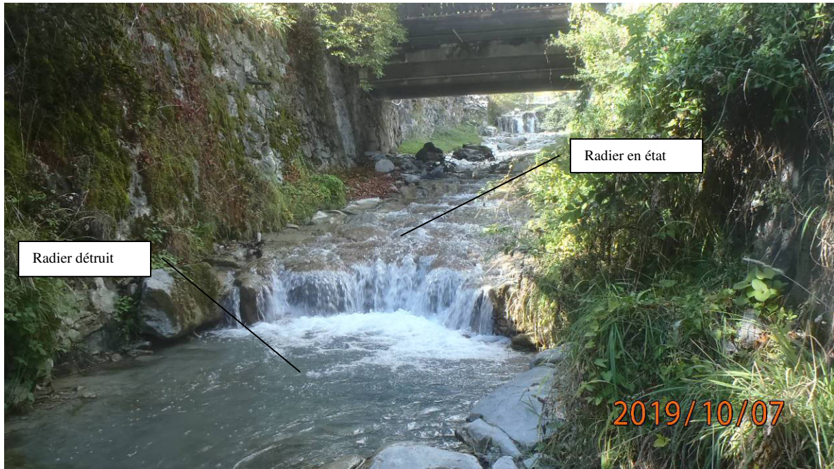
Figure 22 Juste en aval du pont routier sur la RD 89. Très gros affouillement du radier.
