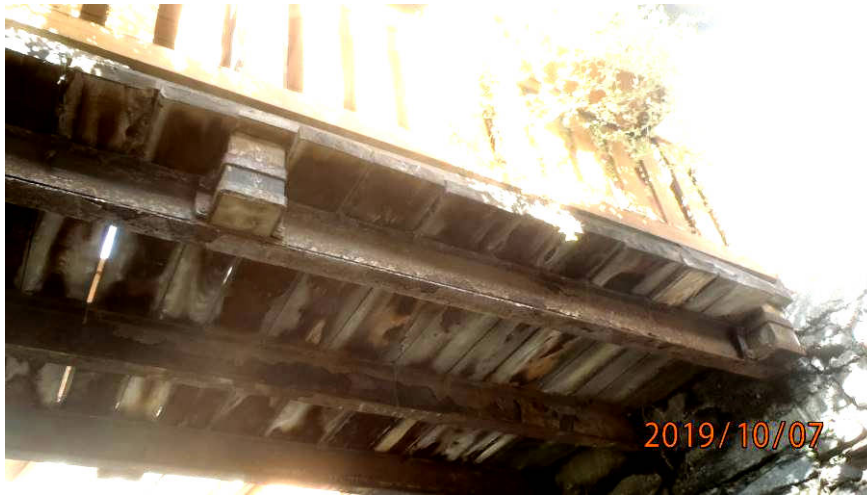
Figure 10 Les fers porteurs de la passerelle piétons. Ils sont très oxydés. Ils demanderaient à être contrôlés, protégés ou remplacés.
