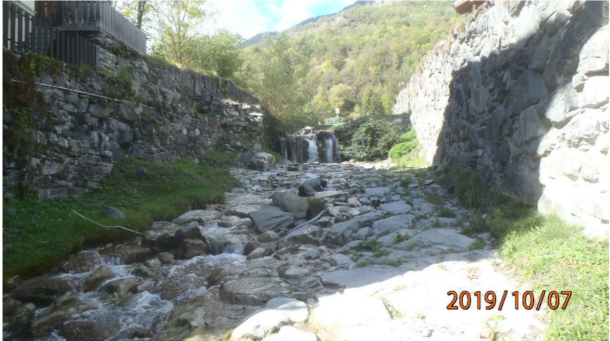
Figure 25 Le radier entre le pont de la RD 89 et le seuil de prise d'eau. Le radier est encore en bon état bien que légèrement dégradé en rive droite.
