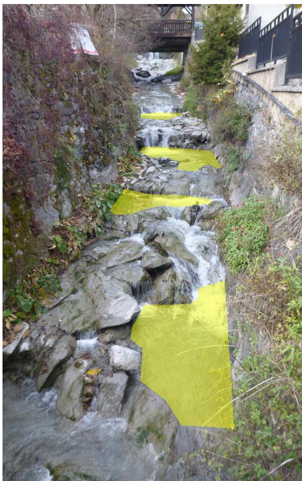
Affouillement du pavage entre les ponts de la RD 89 et de la RD 915
