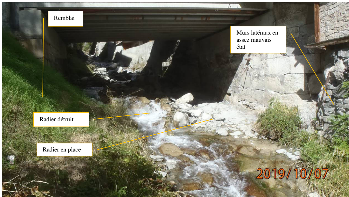
Figure 8 Le fond de lit entre le seuil et le pont de la RD 915. On remarque le pont et ses culées en parfait état, des dépôts terreux en rive droite, le radier détruit en milieu de lit ainsi que les murs latéraux de part et d'autre du pont qui sont en assez mauvais état.
