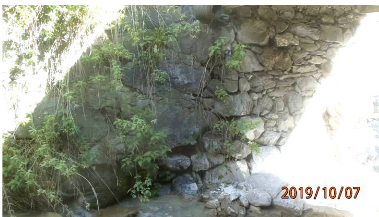
Figure 19 Mur latéral en mauvais état
