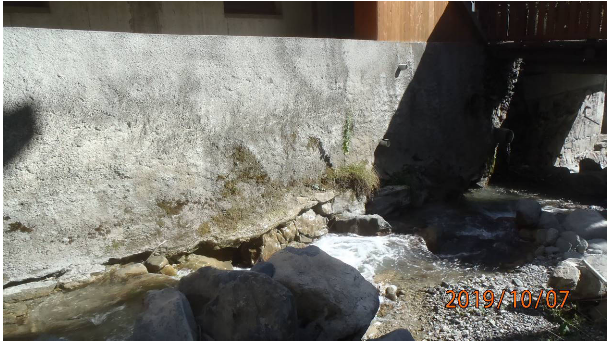
Figure 14 Autre vue de l'affouillement de rive gauche au droit de l'immeuble
