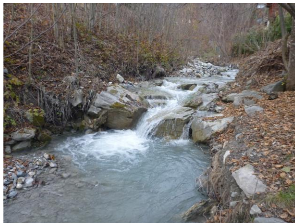
Seuil de stabilisation du lit OH2 difficilement franchissable en raison de l'affouillement aval (BURGEAP)
