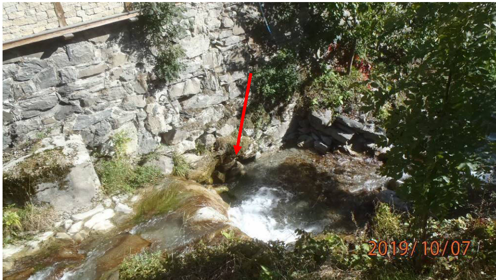
Figure 7 Affouillement ponctuel de la digue juste en aval du seuil
