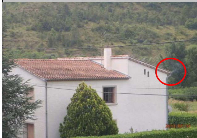
Photographie du défaut
