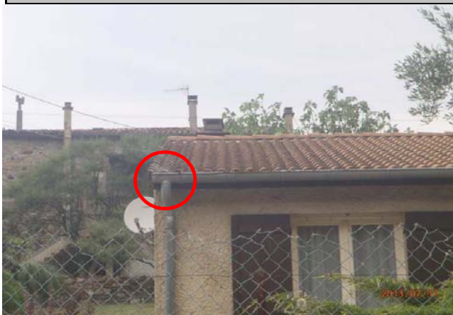
Photographie du défaut
