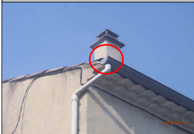
Photographie du défaut
