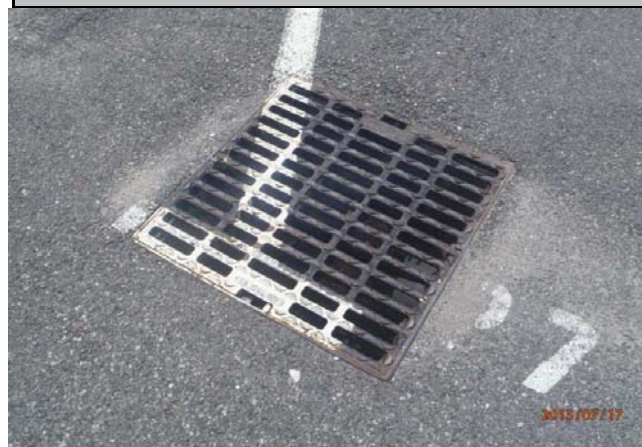
Photographie du défaut
