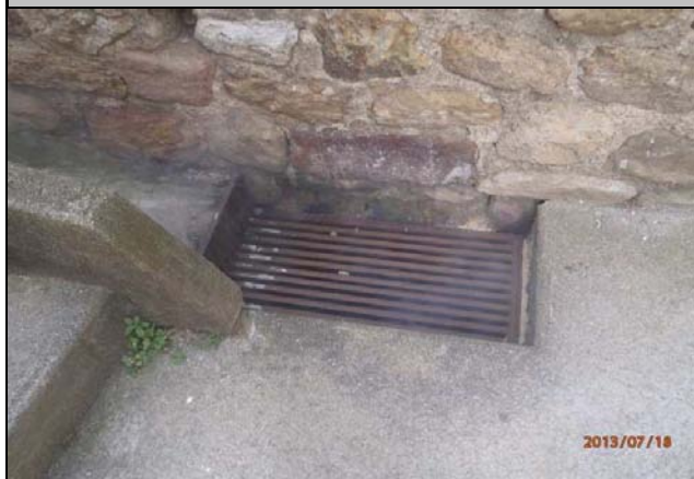
Photographie du défaut
