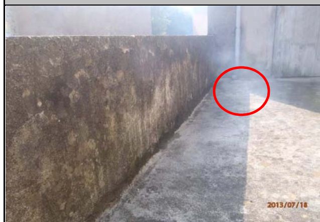
Photographie du défaut
