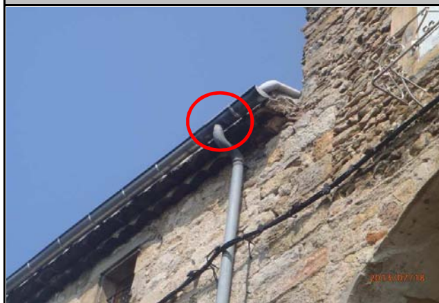
Photographie du défaut
