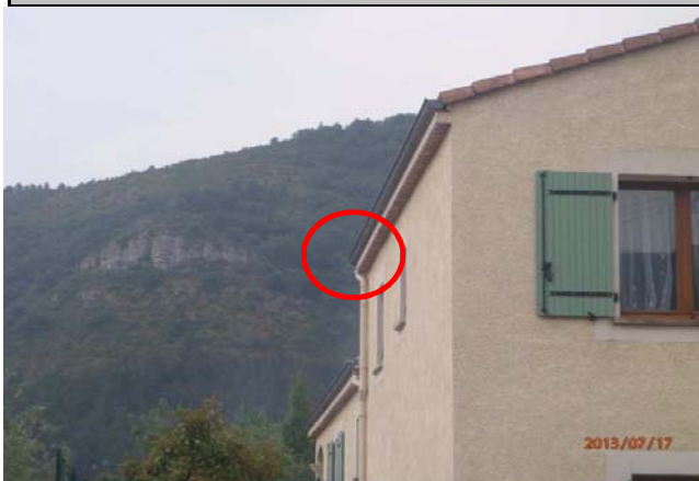
Photographie du défaut
