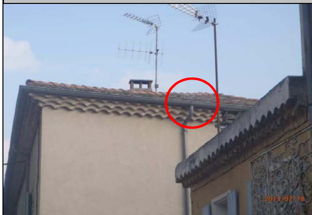
Photographie du défaut
