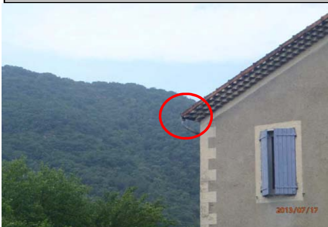
Photographie du défaut
