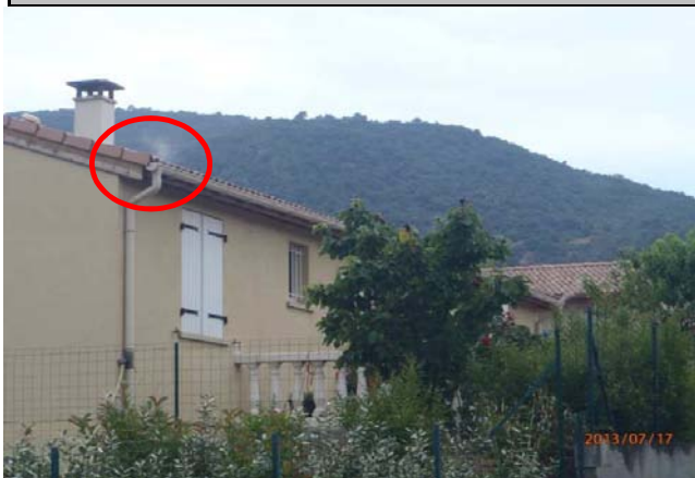
Photographie du défaut
