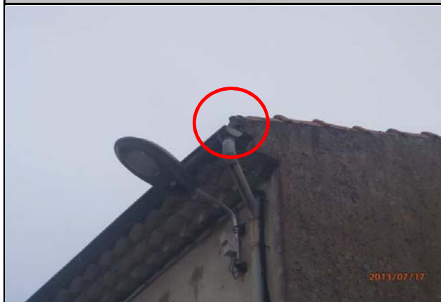
Photographie du défaut
