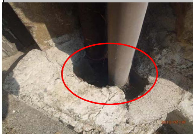
Photographie du défaut
