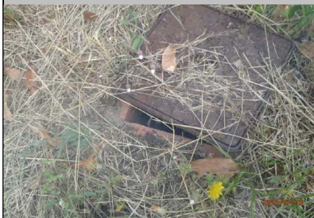
Photographie du défaut
