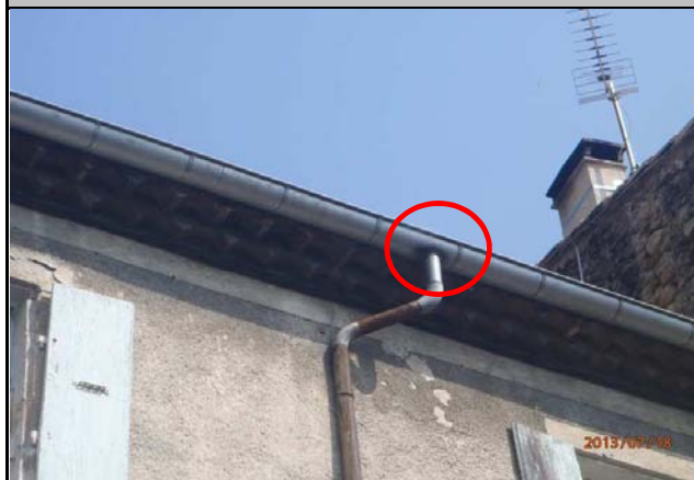
Photographie du défaut
