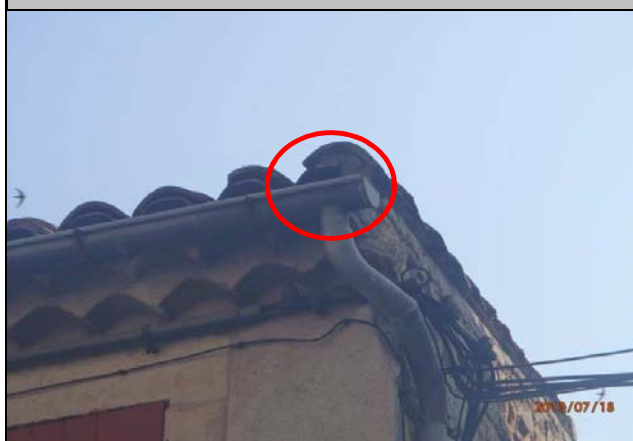
Photographie du défaut
