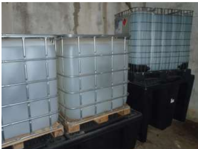
Cuves de produits chimiques, sur bacs de rétention
