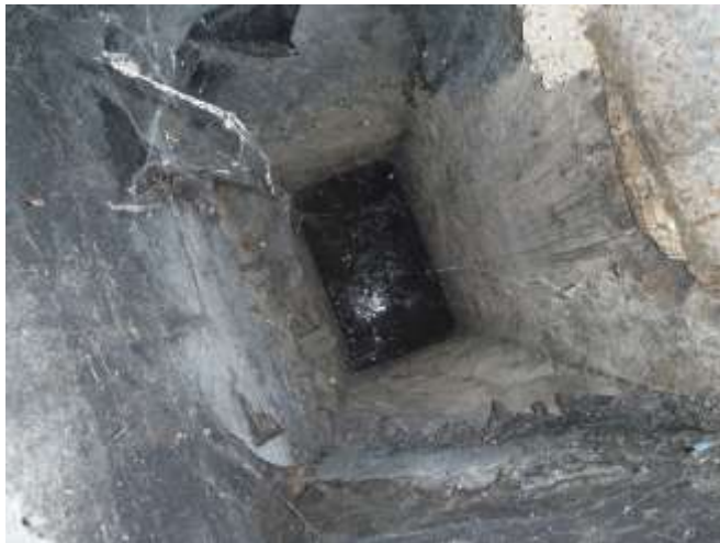
Réseau collectif qui traverse un bâtiment – aspect vétuste
