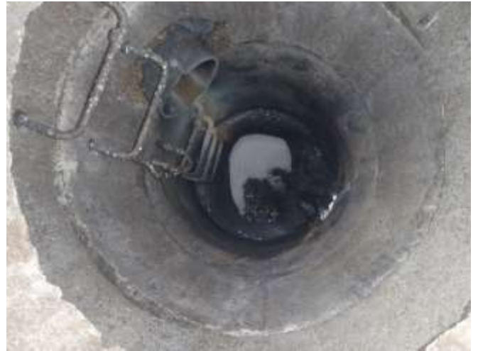
Rejet d'eaux usées industrielles dans le réseau collectif Les effluents sont parfois noirs car du noir de carbone est ajouté
