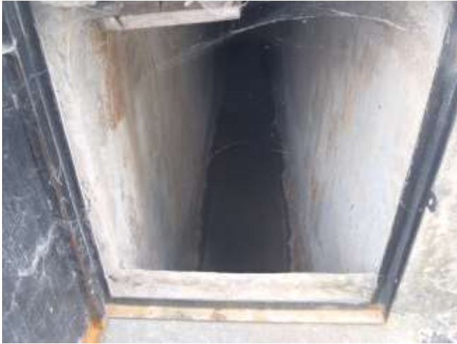
Réseau collectif qui traverse le site
