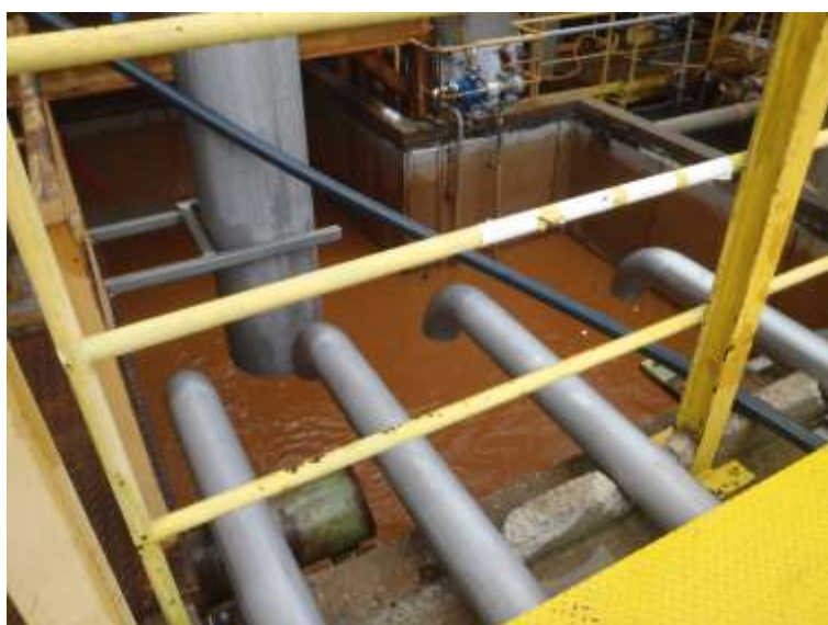
Cuve de rétention
