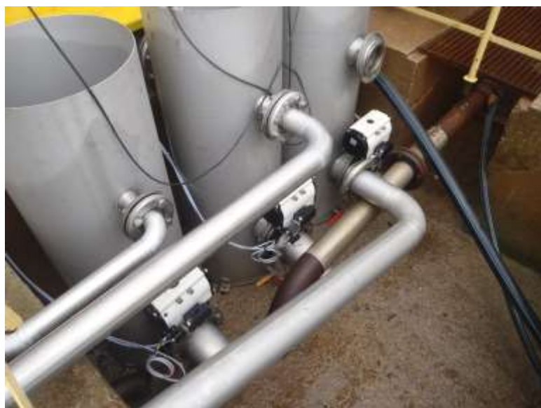
Vue des installations
