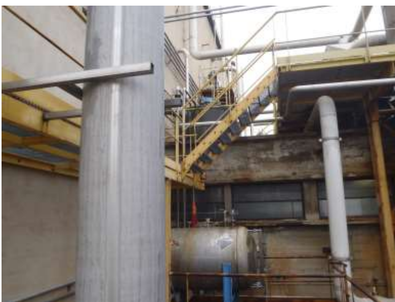
Vue des installations
