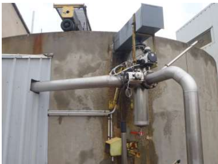
Système de pompage du bassin d'aération
