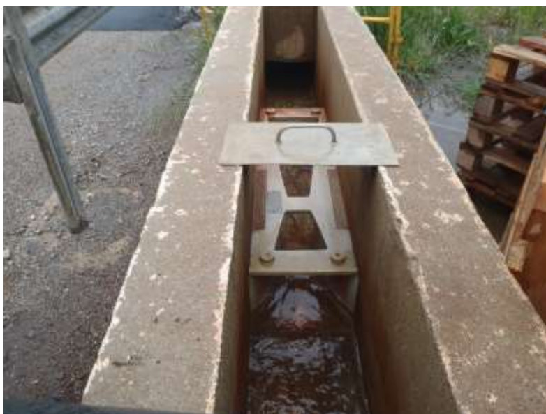
Canal Venturi, en sortie de station d'épuration
