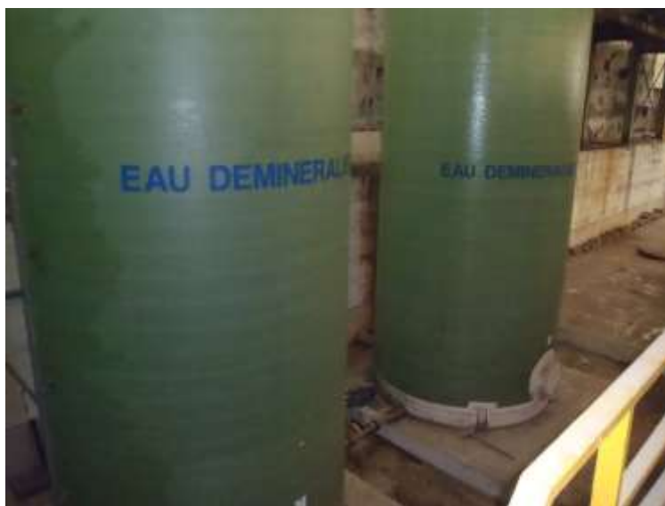
Etape de déminéralisation de l'eau
