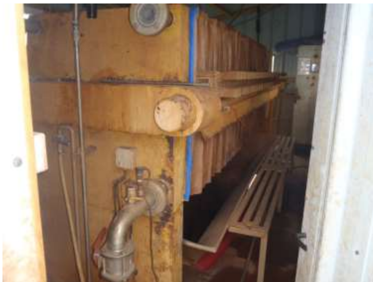
Vue des installations
