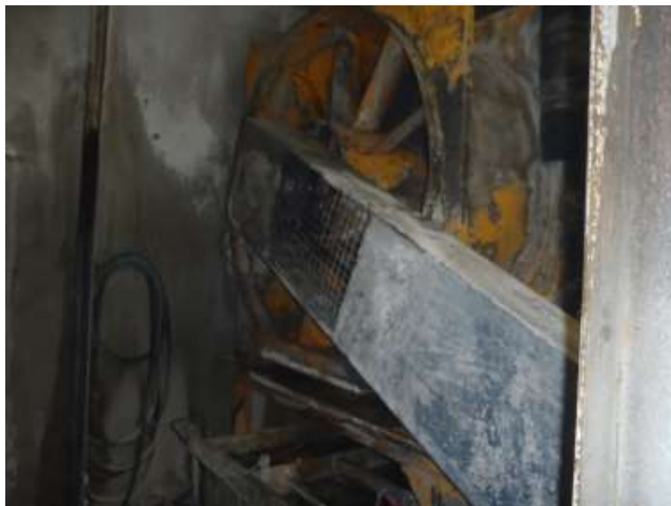
Vue des installations
