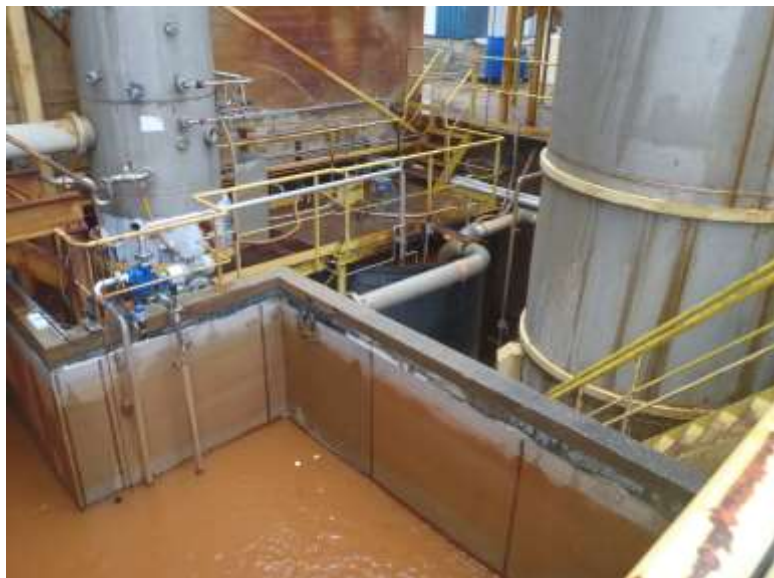
Cuve d'acide, sur bac de rétention
