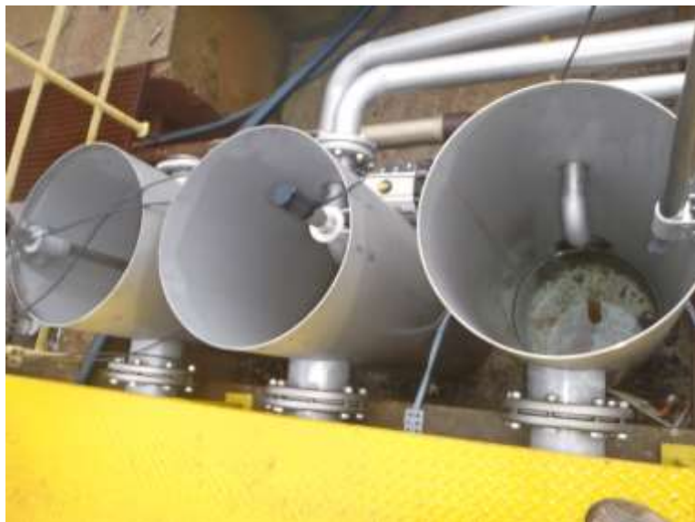
Vue des installations
