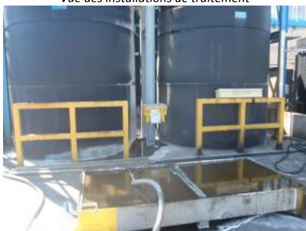
Vue des installations de traitement
