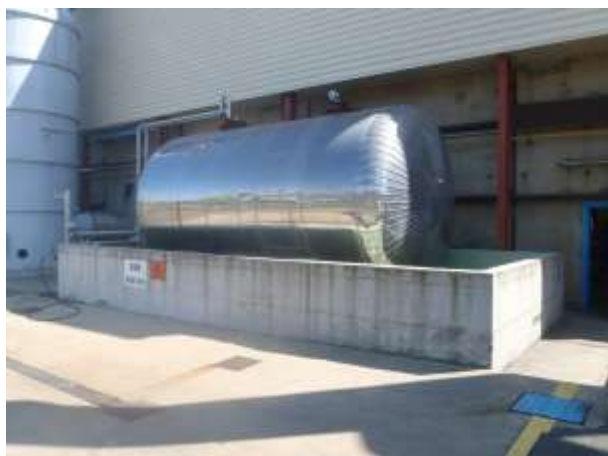
Cuve de soude
