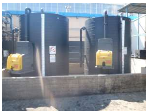
Cuves de chlorure ferrique et acide sulfurique
