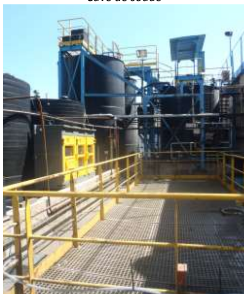
Vue des installations de traitement
