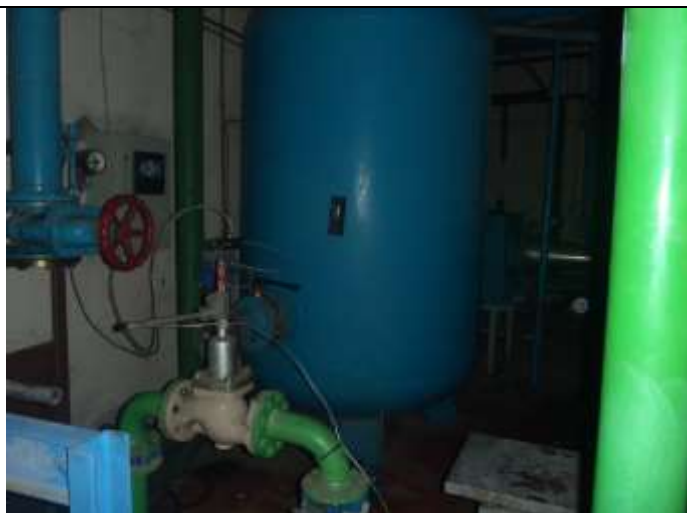
Traitement de l'eau brute
