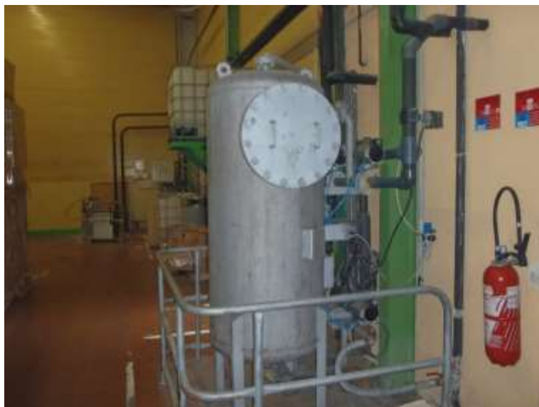
filtre à sable
