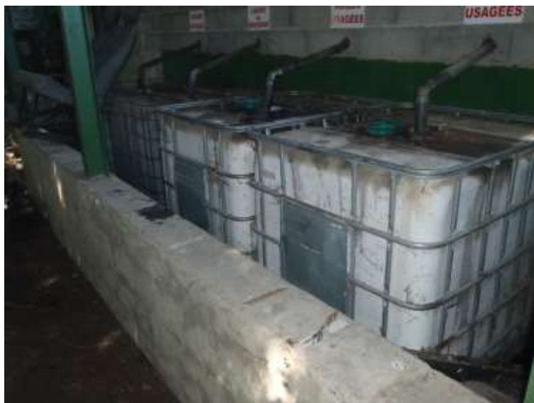
Cuves de récupérations sur cuve de rétention : lave glace, liquide de refroidissement, huiles usagées.
