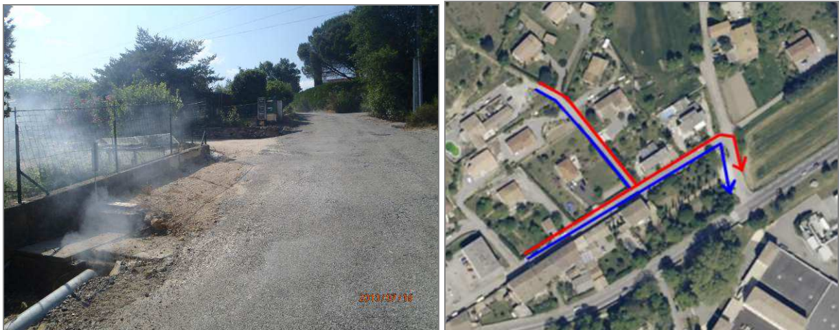
Illustration n°10: Photos d'anomalies à la fumée : Raccordement du pluvial sur l'assainissement rue André Bernard
