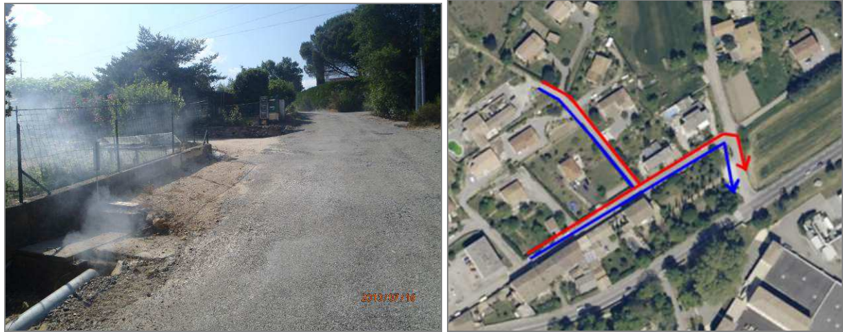
Illustration n°8: Photos d'anomalies à la fumée : Raccordement du pluvial sur l'assainissement rue André Bernard
