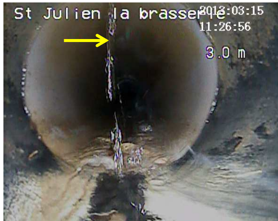
Infiltration au niveau du regard 246 (jonction réseau/regard) \approx 0.72 \text{ m}^3/\text{h}
