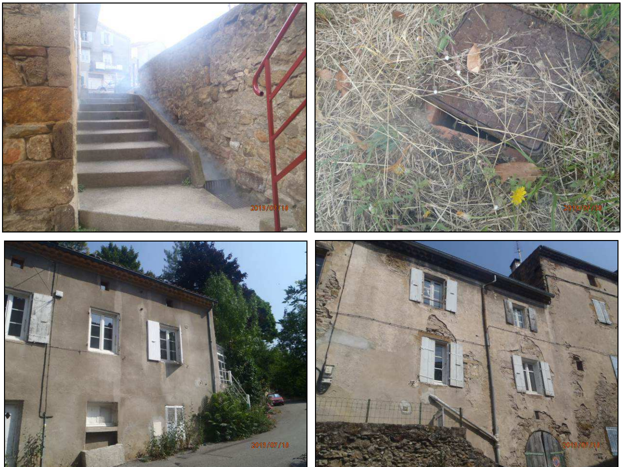
Illustration n°6: Photos d'anomalies à la fumée : Grilles pluviales (HG), boîte de branchement (HD) et gouttières raccordées (B)
