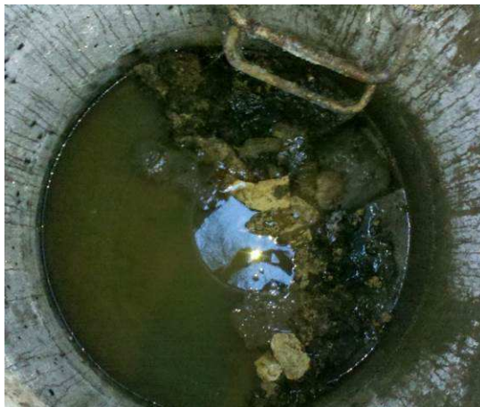
Regard de visite n°166, entre La Branche et Les Cornes
