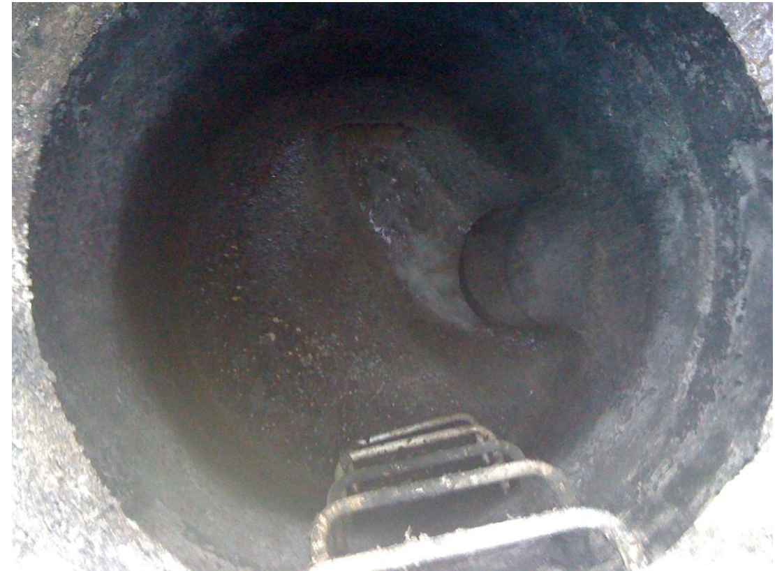
Vue de l'intérieur du RV 68 : effluents en provenance de la ZI du Lac
