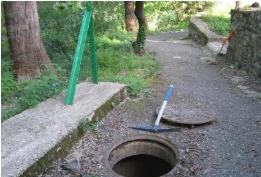
Vue extérieure du RV79, implanté sous chemin communal, en amont du regard supportant le nouveau DO (regard non relevé)
