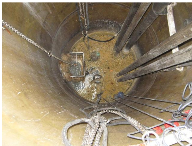
Vue intérieure de la cuve
