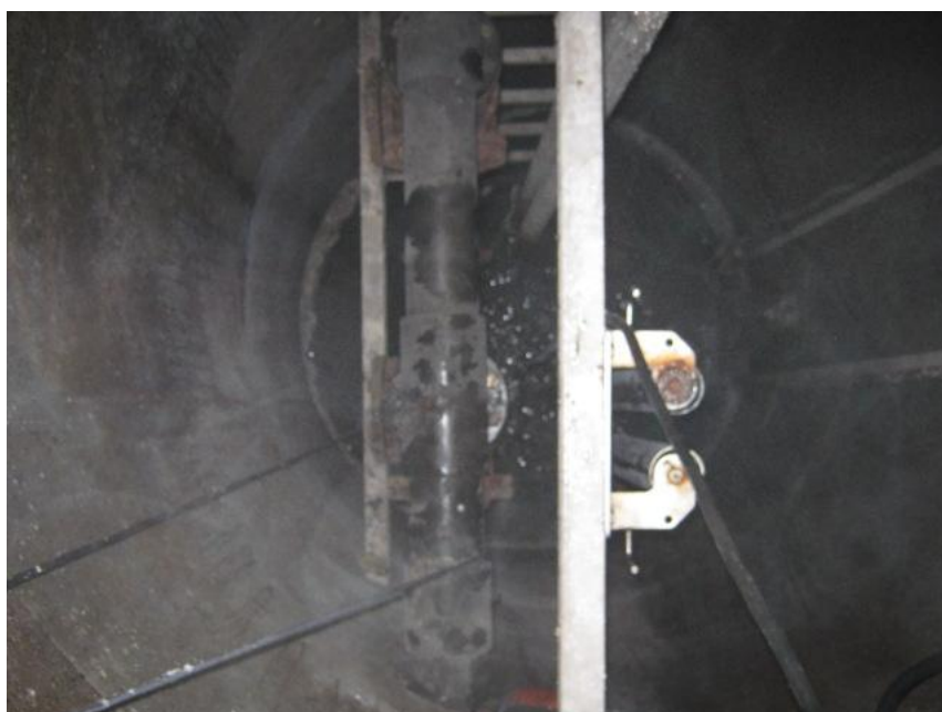
Vue intérieure de la cuve
