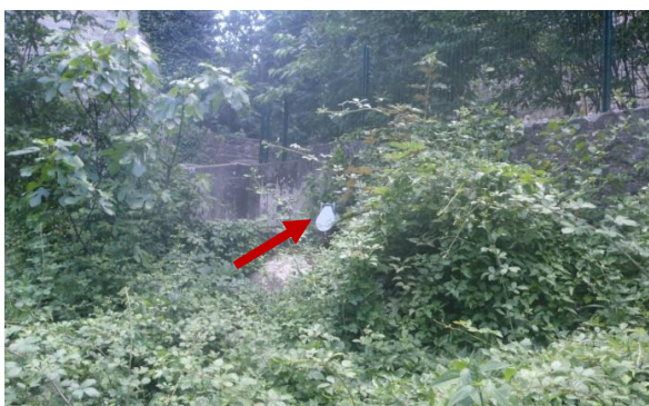
11- Vue sur l'exutoire du déversoir d'orage des pompiers. La conduite est équipée d'un clapet anti-retour.
