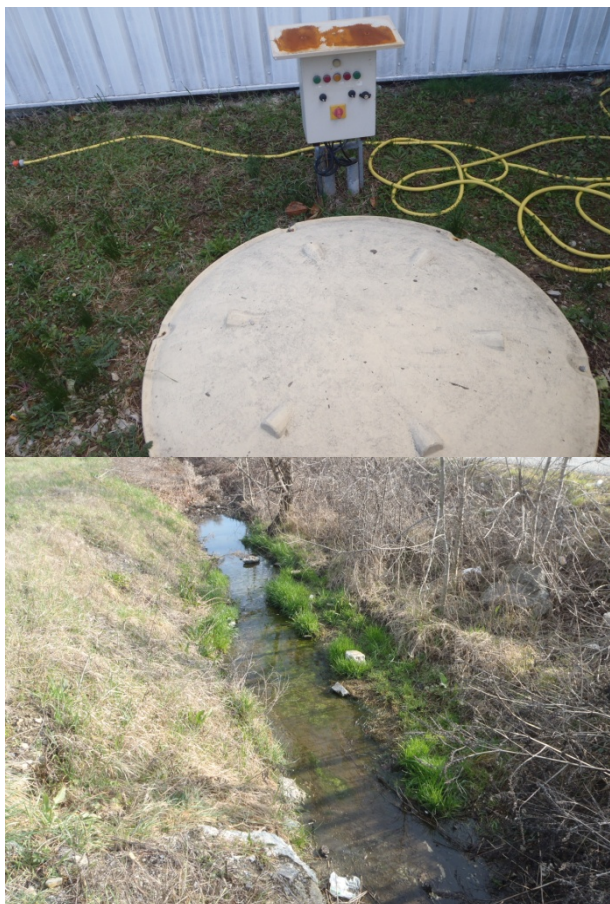
Figure n°8 : Construction Electrique du Vivarais - Poste de refoulement et rejet pluvial
