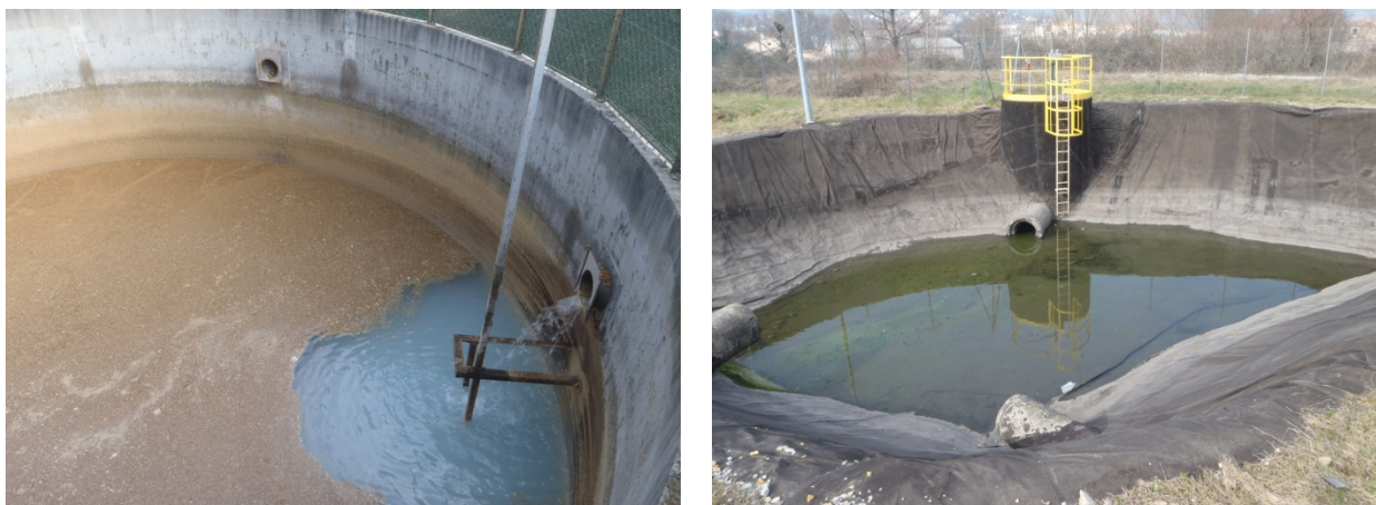
Figure n°5 : Bostik SA - Vue des prétraitements (Eaux de lavage / Eaux pluviales)
