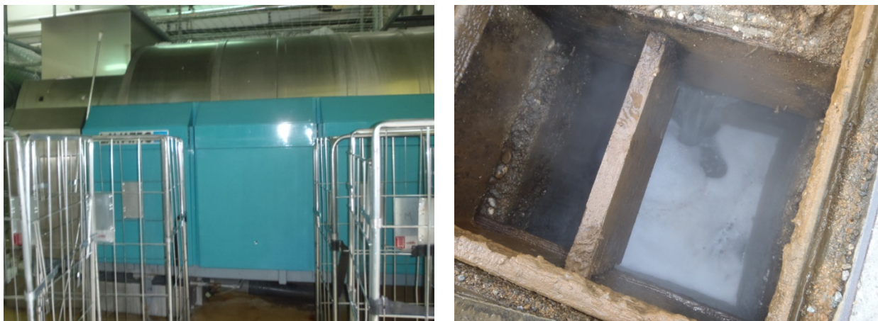
Figure n°11 : Centre hospitalier des Vals d'Ardèche - Blanchisserie (tunnel de lavage et rejet)
