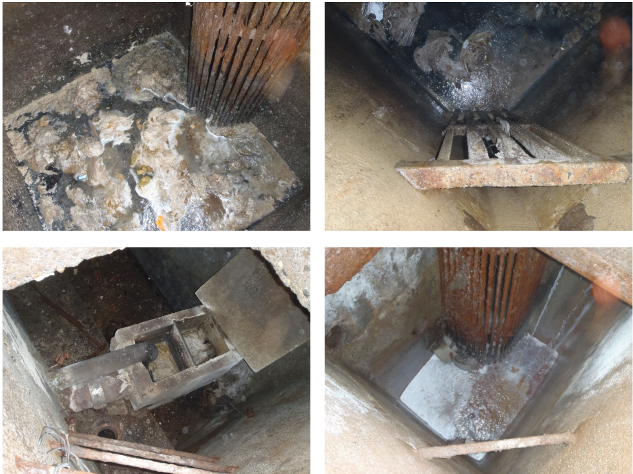
Figure n°14 : Hôpital Sainte-Marie - Fosses et dégrillage grossier
