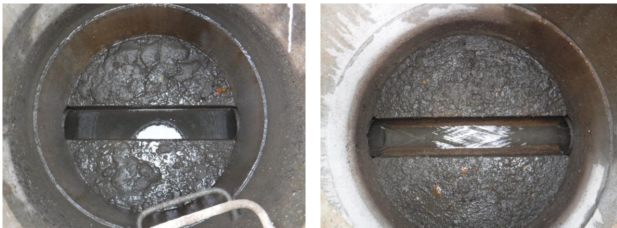
Infiltrations – réseau à travers champ amont STEU - ID 13 et 16
