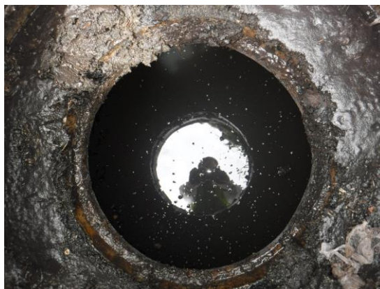
Vue intérieure dessableur situé chemin de Nanceau
