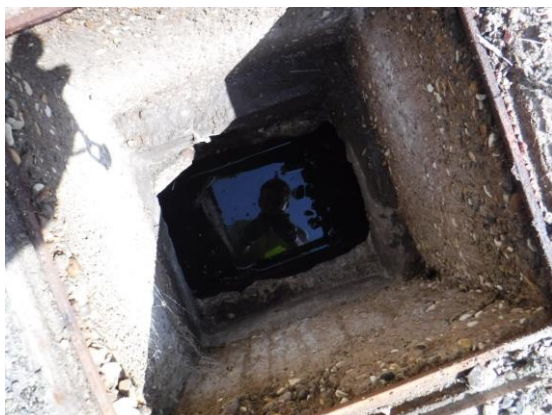
Stagnation d'effluent- RD 49 angle chemin de Nanceau- ID 100
