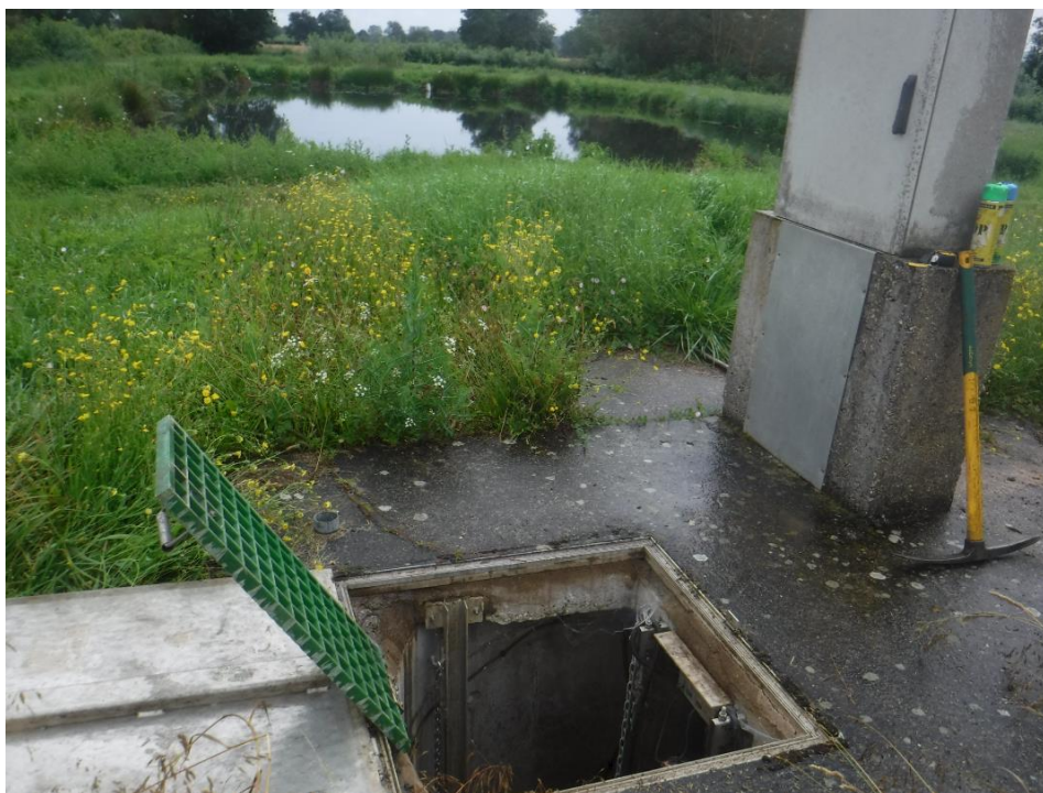
Poste de relèvement situé à la lagune
