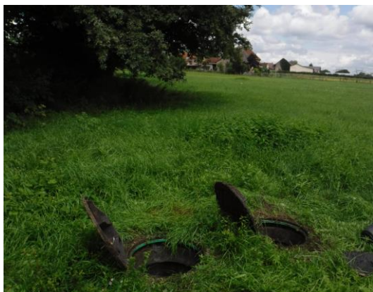
Vue extérieure dessableur situé chemin de Nanceau
