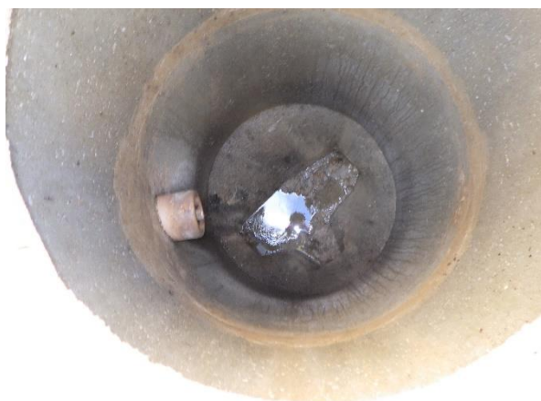
Dépôts, Stagnation d'effluent – Rue de la Forêt – Système de Quintaine – ID 438
