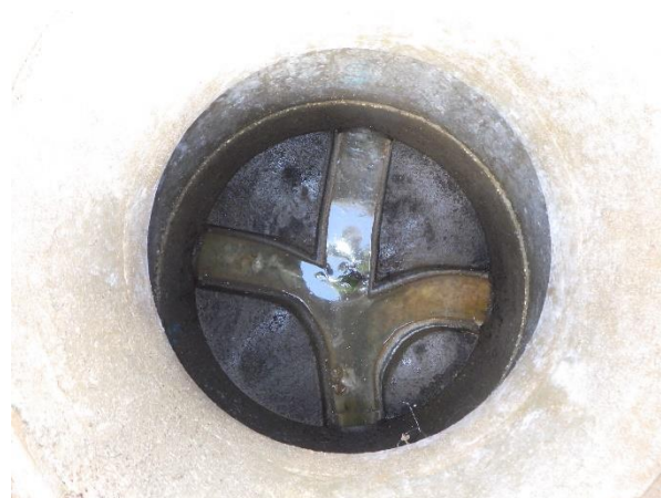
Stagnation d'effluents – Chantot – Système du Bourg – ID 254
