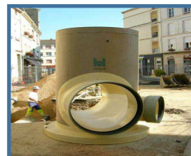
Aperçu d'un regard en PRV
