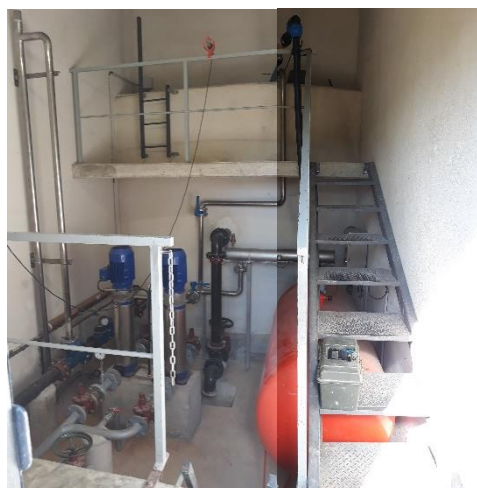
Figure 13 : Réservoir Les Voltes - vue intérieure
