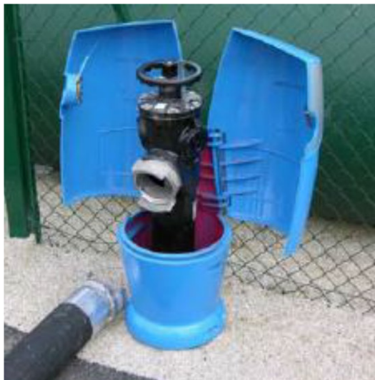
Exemple de poteau d'aspiration
