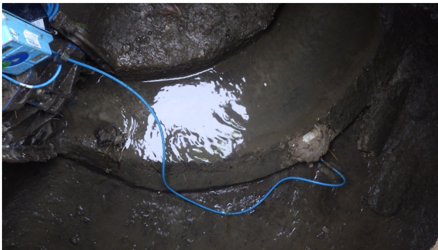
Figure 29 : Déversoir d'orage de Lavans les Quingey
