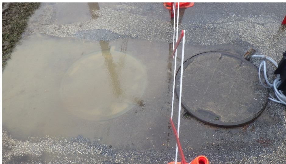
Figure 15 : Réseau en charge M4
