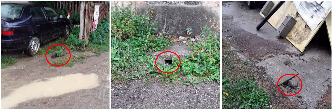
Figure 74 - Photographies de certains avaloirs connectés au réseau EU après mise en séparatif des réseaux
