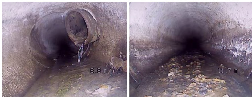
Figure 60 – Localisation de la connexion de la fontaine sur le tronçon RV13 → RV14 et présence de dépôts
