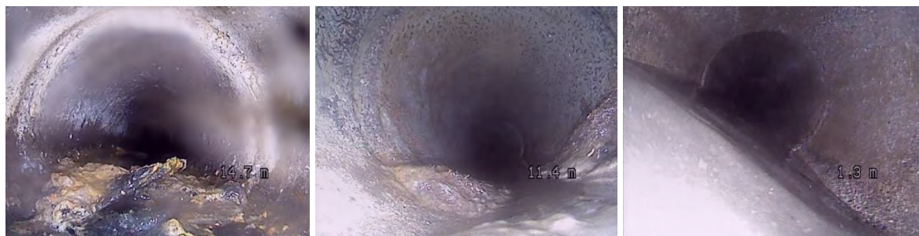
Figure 59 - Anomalies constatées par caméra sur le secteur Pré Grand
