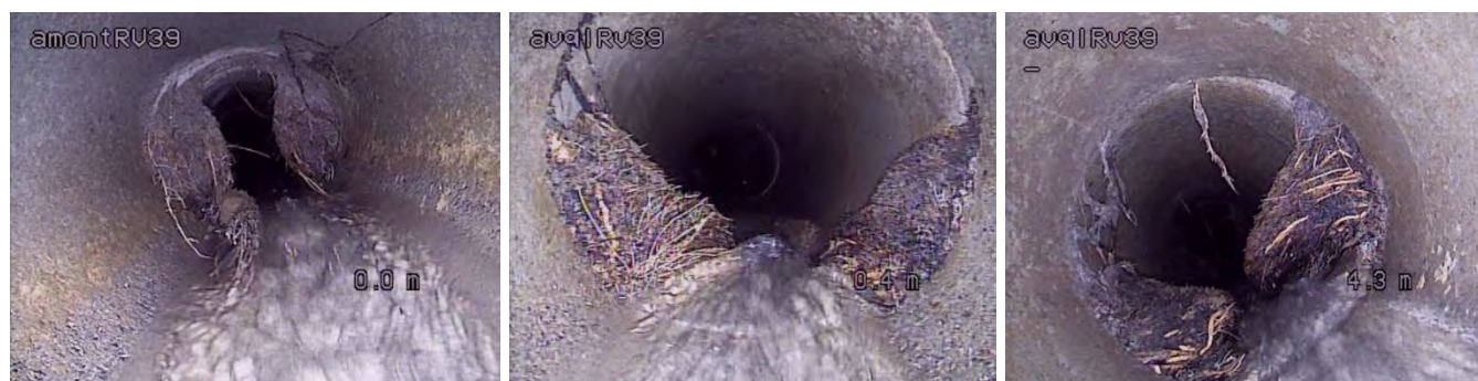
Figure 62 – Infiltration massive de racines sur le tronçon entre les regards 37 et 39 ne permettant pas de localiser le RV38
