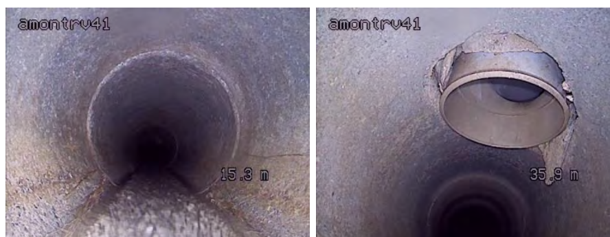
Figure 63 – Localisation de la connexion du drainage du cimetière au réseau d'assainissement par caméra
