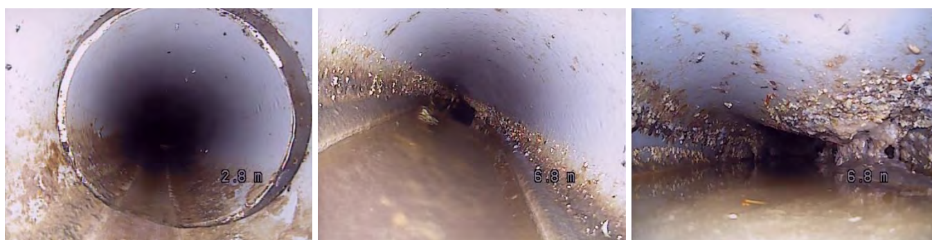
Figure 90 – Décalages entre éléments et déformations des canalisations, tronçon RV 106 → RV 107
