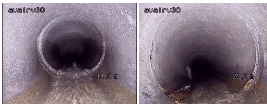
Figure 61 - Exemple d'anomalies constatées par caméra sur le tronçon de rejet du Chef-Lieu Est
