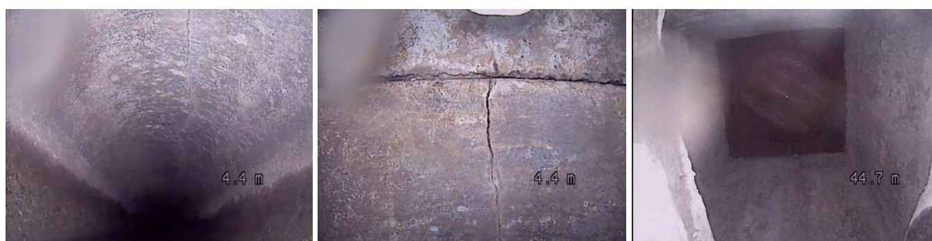
Figure 65 - Présence de fissures longitudinales et localisation d'un regard de visite sous chaussée
