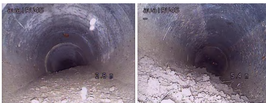
Figure 64 - Canalisation de rejet du DO (RV45) non visitable car ensablée
