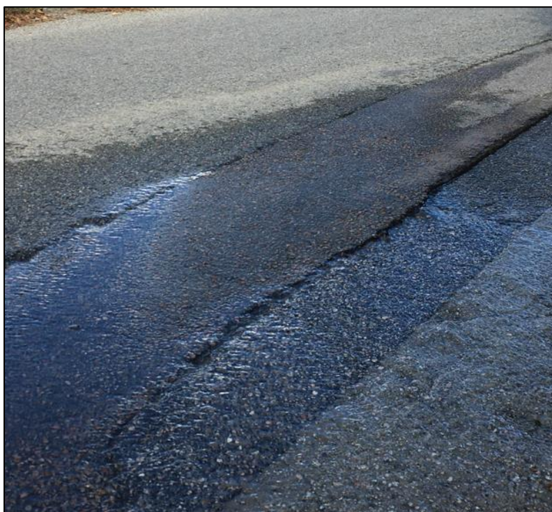
Figure 16 : Vue d'une casse sur le réseau en amiante ciment reliant Meulien à Florida
