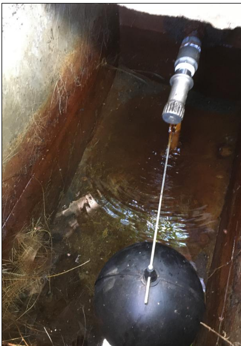
Figure 18 : Vue du brise charge entre Casaracca et Meulien
