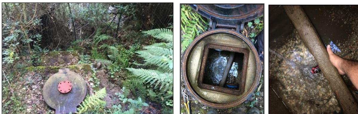
Figure 8 : Vues du captage de la source de Sambuchetto 1
