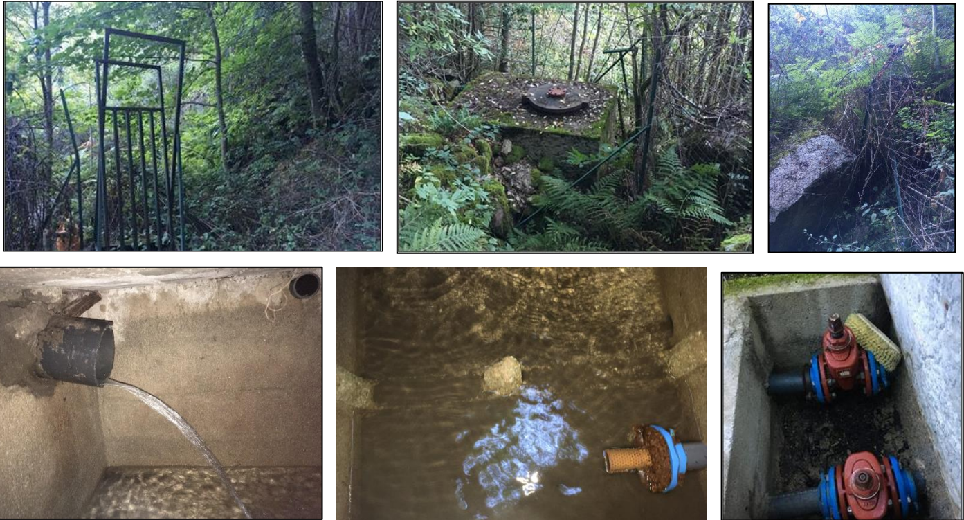
Figure 9 : Vues du captage de la source de Sambuchetto 2
