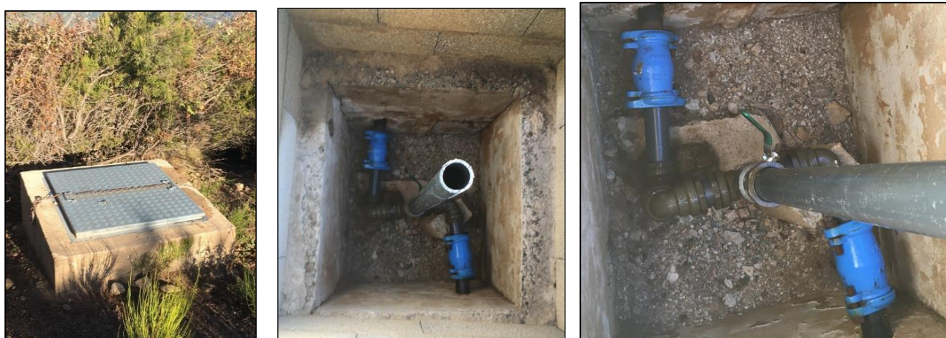
Figure 12 : Vues du brise charge sur le réseau d'adduction de la source d'Isa
