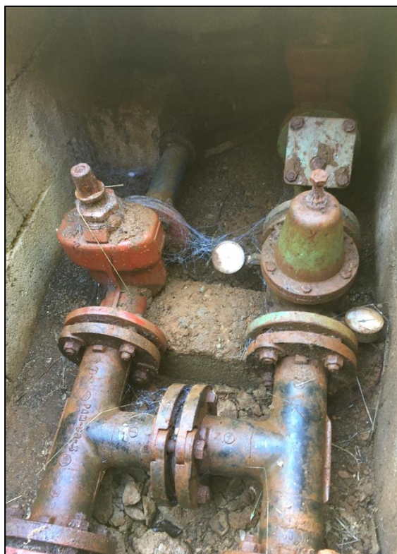
Figure 19 : Vue de la chambre de vanne avec réducteur de pression en amont du réservoir de Florida
