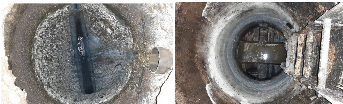
Figure 23 : Regards intérieurs concernés par des intrusions d'eaux claires (Source : CENEAU, Nocturnes 2021)
