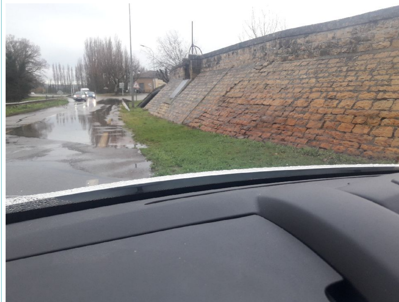
Casse induisant des rejets (sources : Techniform et CCPRO)
