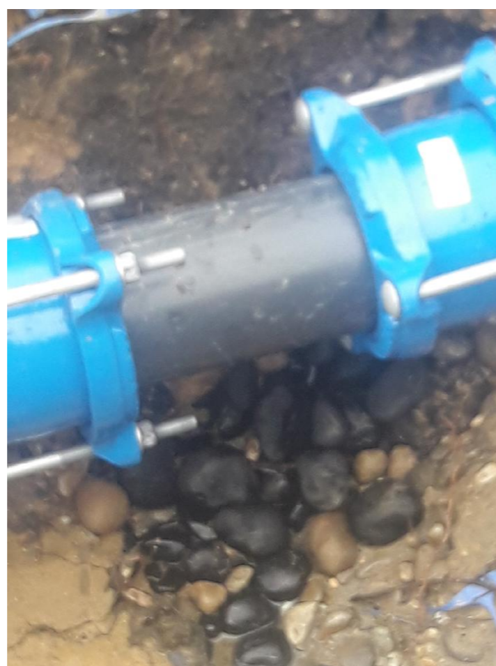
Galets présents initialement dans la canalisation
