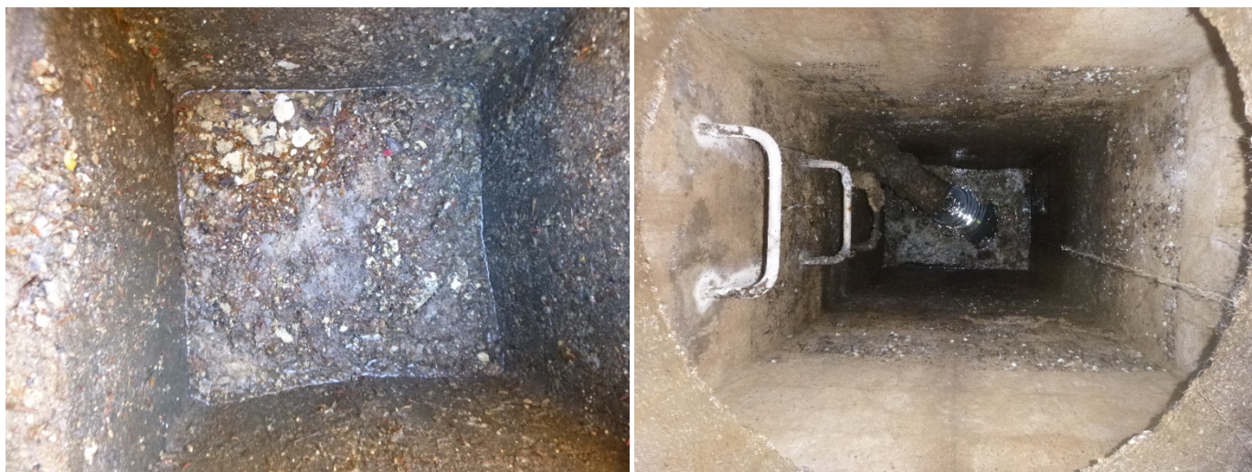
Figure 9 : Exemples de défauts majeurs : Regard fortement ensablé (RV 105) – Infiltration par virole (RV 21)
