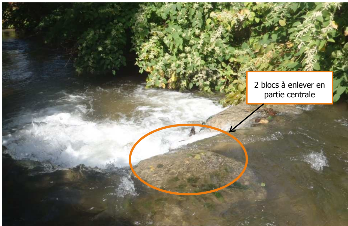
Photo 8 : Seuil en bloc d'enrochements en aval du pont du Curtet
