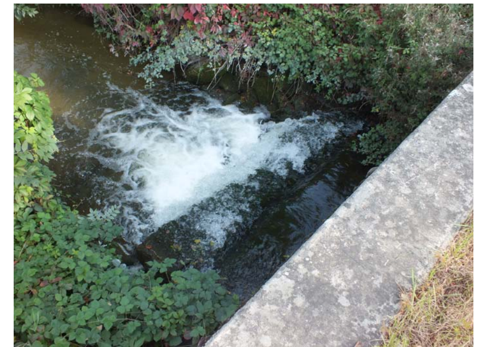
Vue de la chute et de l'élément potentiellement déstabilisé
