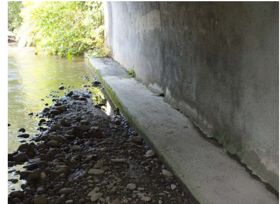
Vue de la fissuration à l'interface culée / banquette
