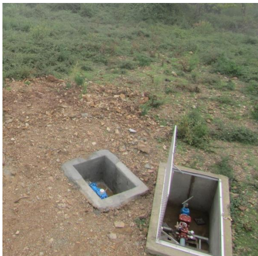
Figure 15 : Vue du regard comportant le compteur de distribution (gauche) et de la vanne altimétrique (droite)
