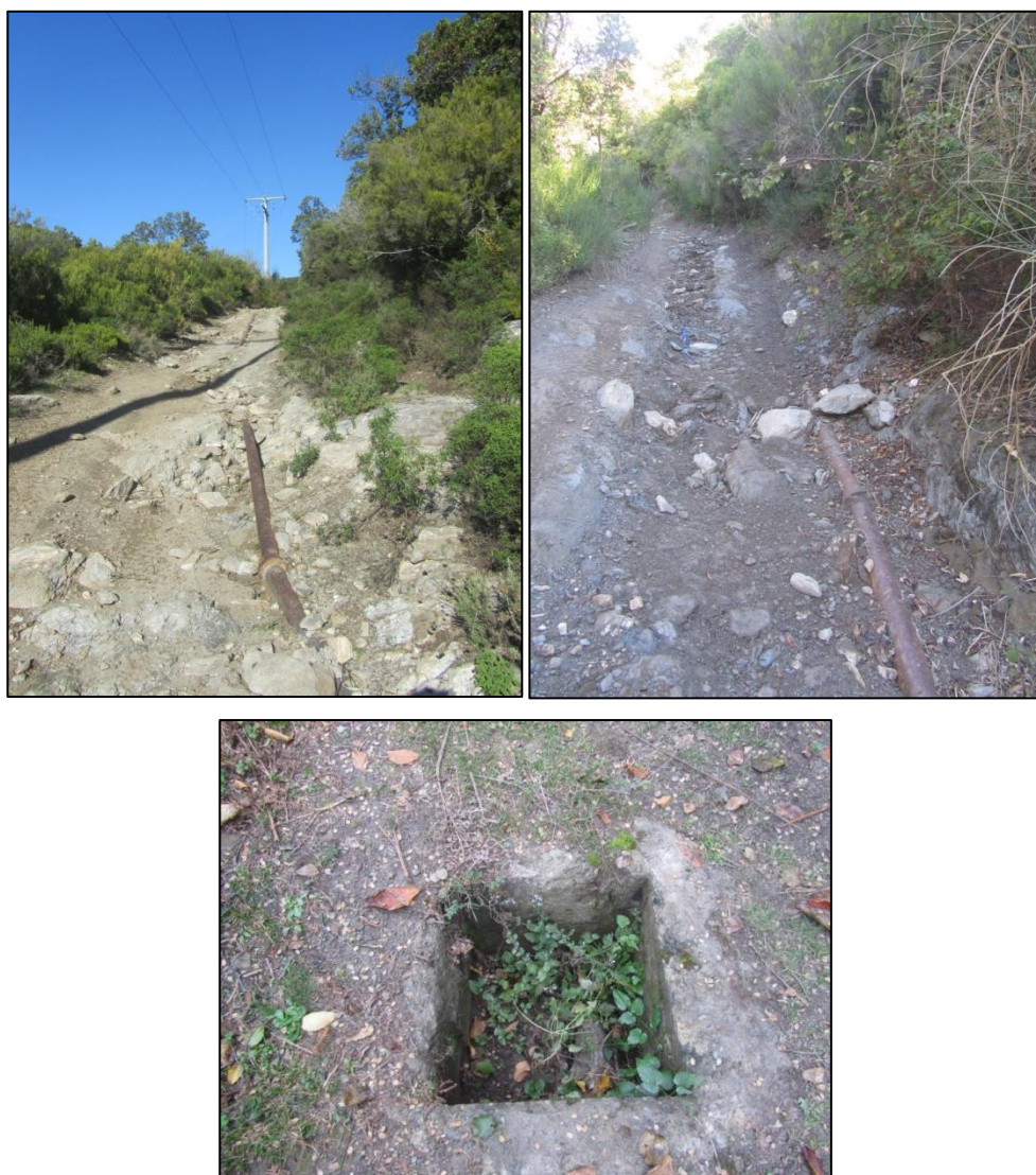
Figure 16 : Photographies d'une partie du réseau et d'une ventouse (hors-service)
