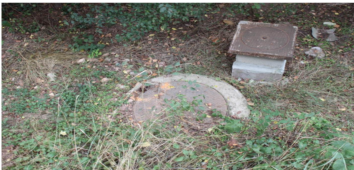
Figure 4; Regards d'assainissement à rehausser et boîte de branchement à mettre en conformité RD 24
