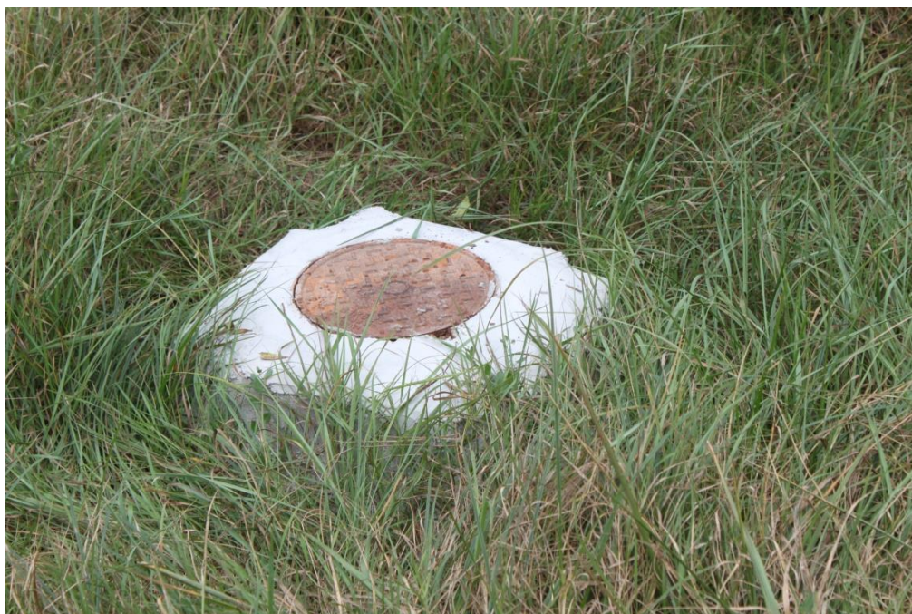
Figure 3: boîte de branchement de Mr Estelle à écarter du ruisseau
