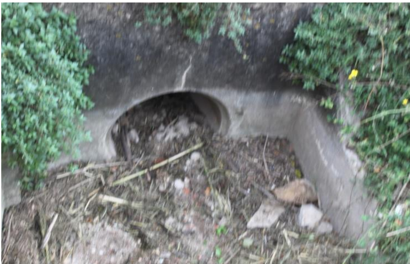
Figure 6: Collecteur pluvial traversant la RD 24 à curer et équiper d'une grille
