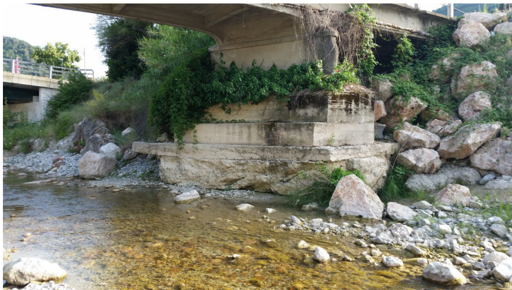
Figure 29 : Culée de pont affouillée à la Pointe de Contes - Idealp
