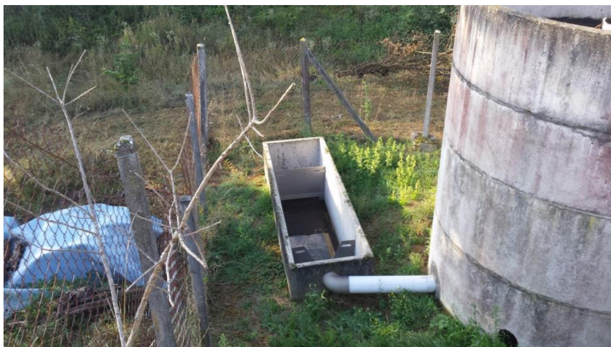
Photo 7 : Canal de sortie de l'effluent traité
