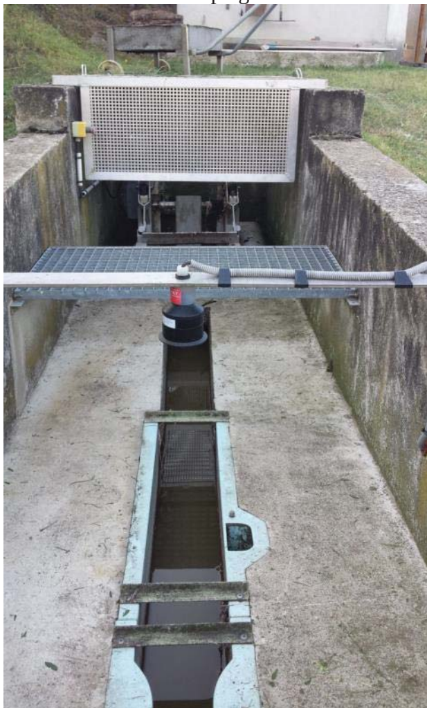
Photo 2 : Canal de comptage
