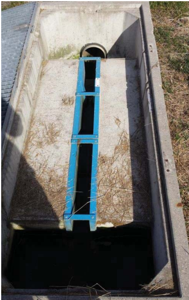
Photo 14 : Canal de comptage de sortie
