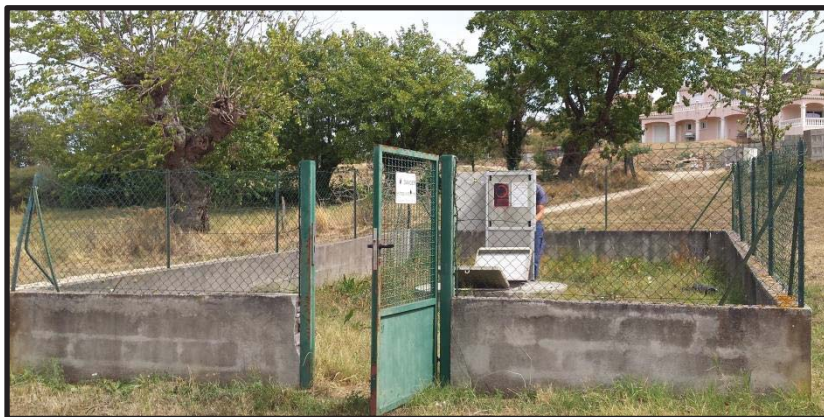
Photo 1 : Vue d'ensemble du poste
