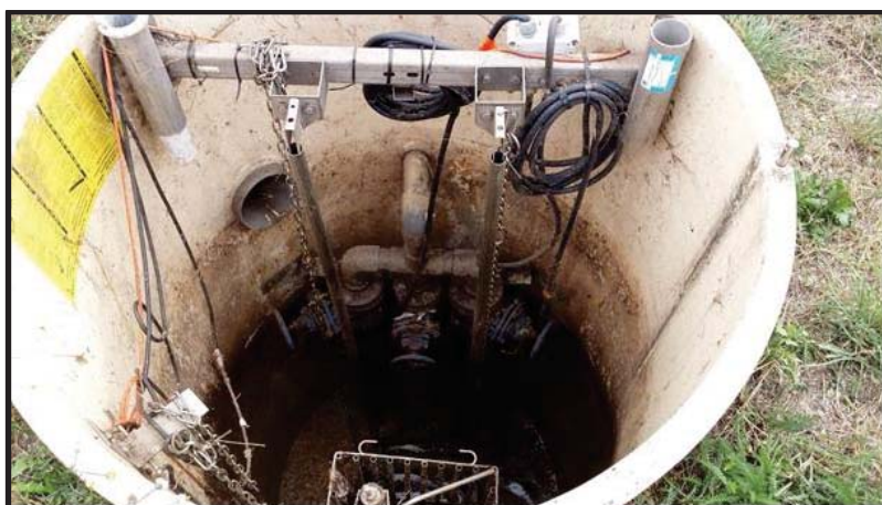
Photo 3 : Vue intérieur du poste
