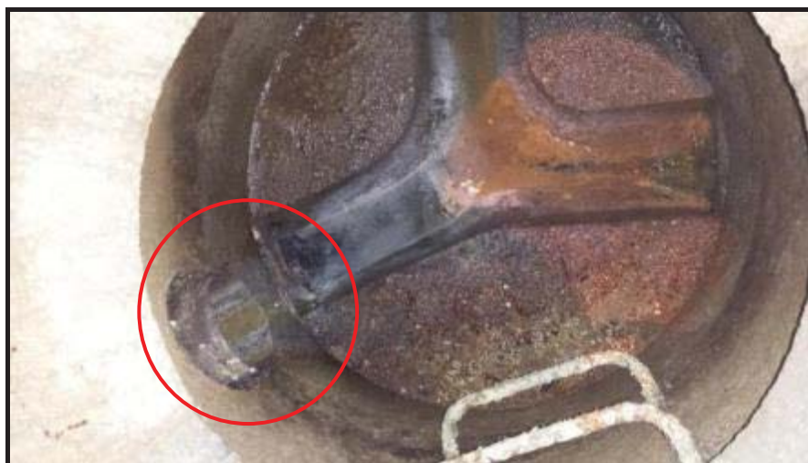
Regard n°393 : Apport dans le regard via le branchement d'un particulier.
