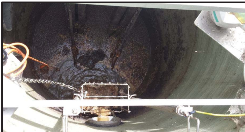
Photo 3 : Vue intérieur du poste
