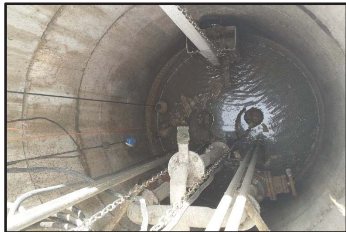
Photo 3 : Vue intérieur du poste
