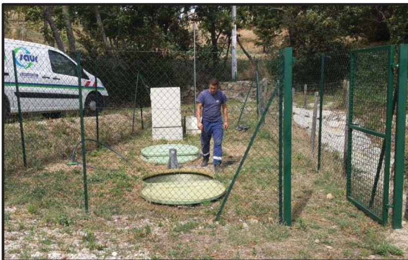
Photo 1 : Vue d'ensemble du poste de refoulement
