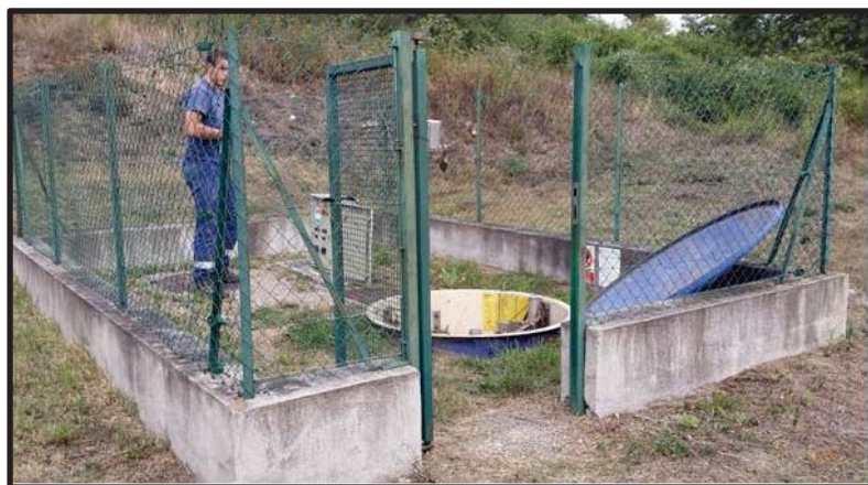
Photo 1 : Vue d'ensemble du poste de refoulement
