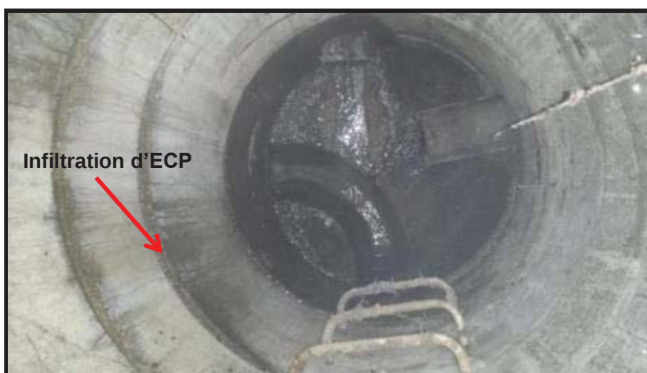
Regard en amont du poste de refoulement de Thoué : infiltration dans le regard, débit non mesurable. Les résultats des apports d'eaux claires par bassin versant figurent dans les synoptiques ci-après :
