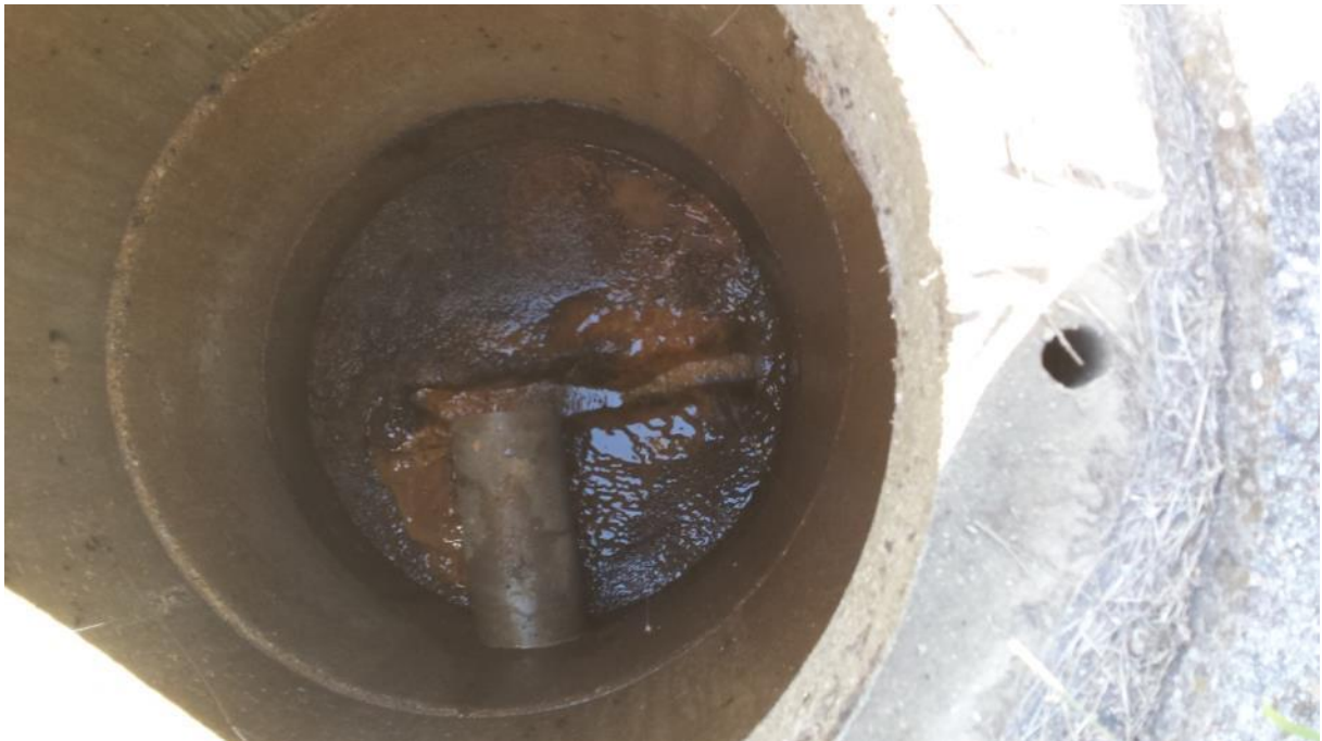
Photo 14 : Regard de sortie
