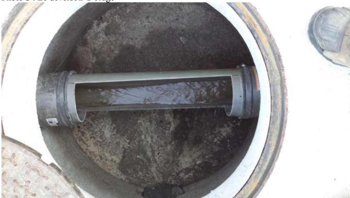
Photo 5 : Le déversoir d'orage
