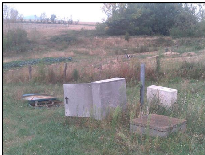
Photo 1 : Vue d'ensemble du poste de refoulement
