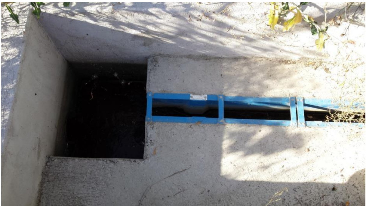
Photo 9 : Canal de comptage de sortie
