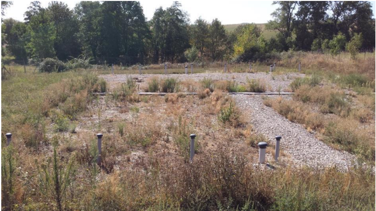
Photo 13 : Filtre à sable
